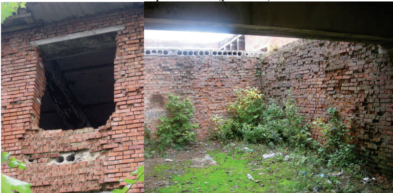
Рис. 2.8. Вивітрювання та руйнування кам'яної кладки будівель
