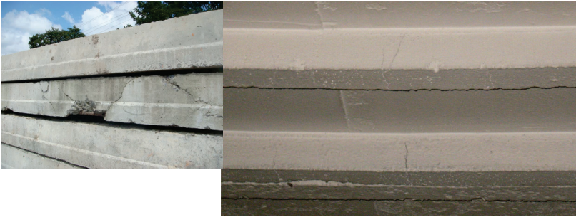
Рис. 2.17. Пошкодження у залізобетонних ребристих плитах
