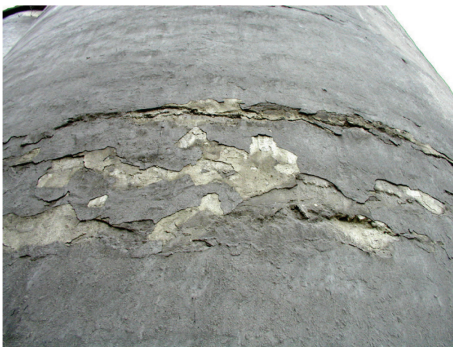
Рис. 2.35. Відшарування захисного шару бетону в силосних корпусах на ділянках влаштування технологічних швів бетонування
