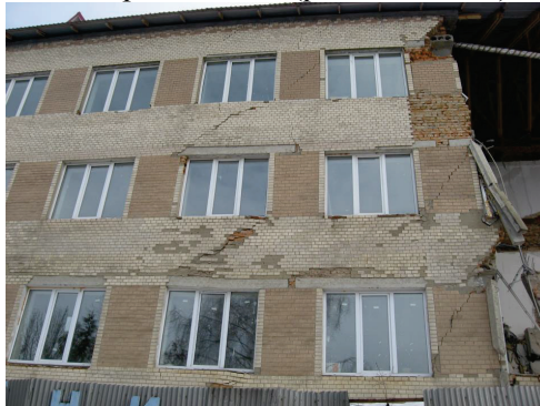
Рис. 2.14. Похилі тріщини у несучій зовнішній стіні поліклініки ЦРЛ м. Ізяслав Хмельницької області
