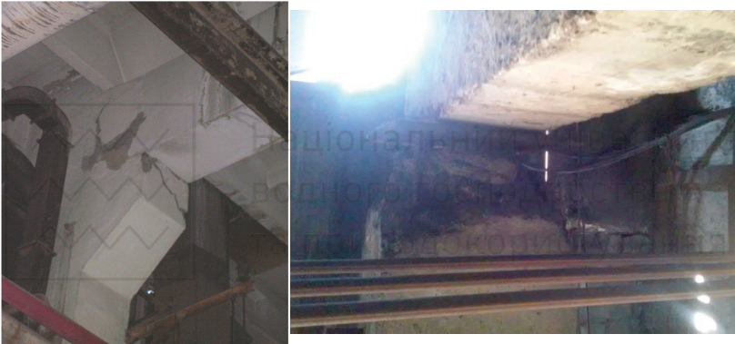
Рис. 2.19. Змінання та зколювання бетону консолі і верхньої частини колони в місці обпирання ригеля та кроквяної конструкції
