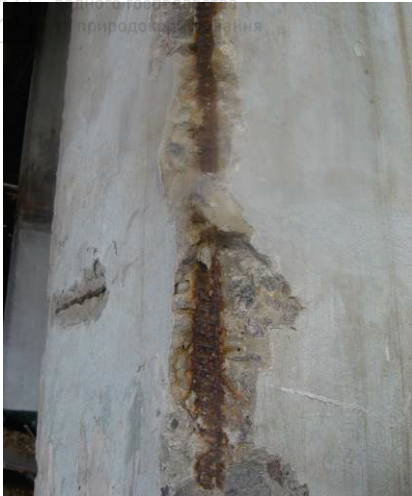
Рис. 2.5. Недотримання та зколи захисного шару бетону, оголені стержні поздовжньої і поперечної арматури в колоні
