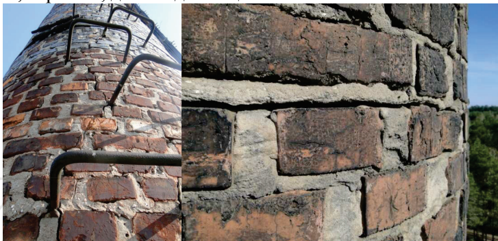
Рис. 2.37. Тріщини у стволі цегляної димовідвідної труби
