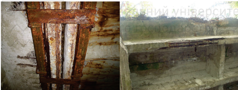
Рис. 2.6. Корозія робочої арматури несучих конструкцій будівель та інженерних споруд
