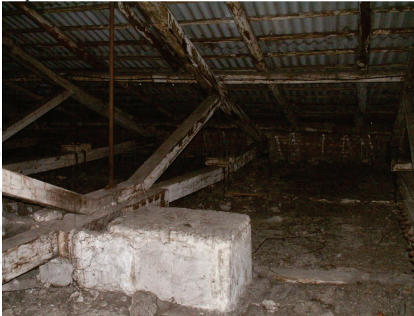
Рис. 2.9. Кров'яна система покриття будівлі уражена гниттям
