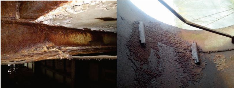
Рис. 2.7. Виразкова корозія металевих конструкцій будівель та інженерних споруд
