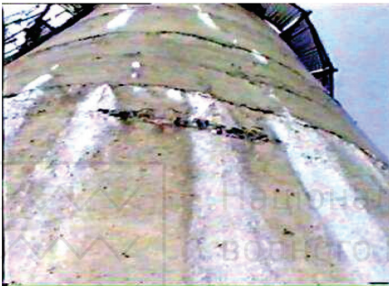
Рис.2.36. Сульфатна корозія бетону, фільтрація вологи на зовнішню поверхню димової труби
