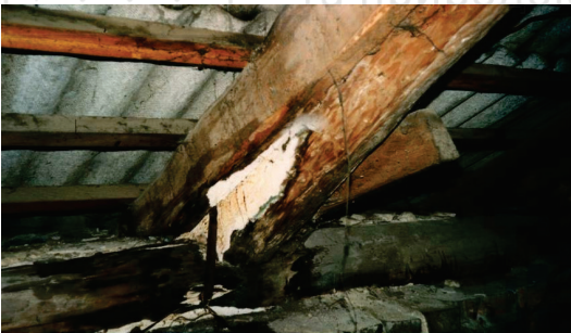
Рис. 2.31. Кроквяна нога покриття будівлі зруйнована гниллю
