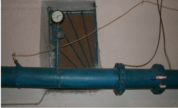
Рис. 5.3. П'єзометричні перетворювачі на трубопроводі з датчиком температури.
