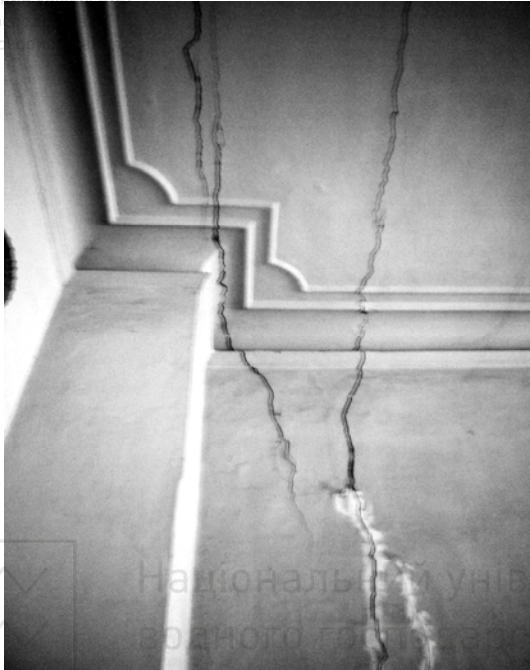
Рис. 2. Руйнування внутрішньої стіни.
