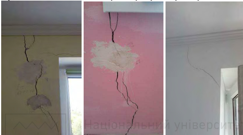
Фото. 3. Тріщини у зовнішніх несучих стінах будівлі
