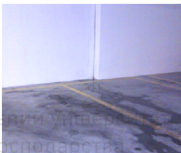
Fotografia. 6. Przeciek z dylatacji konstrukcyjnej.
