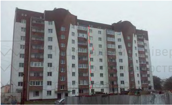
Фото. 1. Фасад будівлі з тріщинами на висоту поверхів
