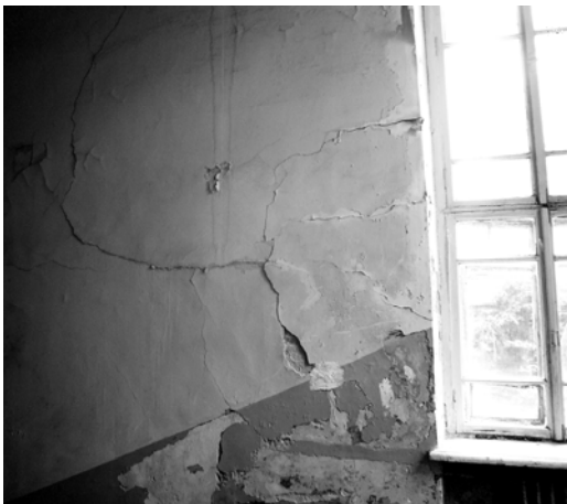
Рис. 1. Руйнування зовнішньої стіни.
