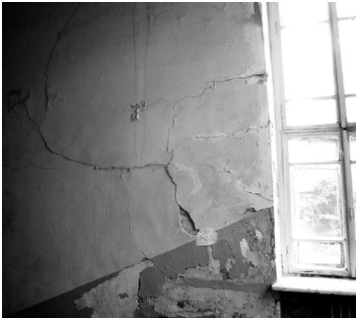
Рис. 1. Руйнування зовнішньої стіни.
