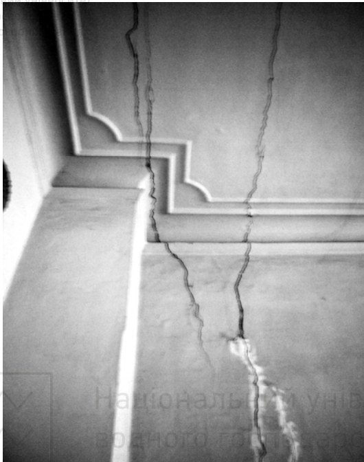
Рис. 2. Руйнування внутрішньої стіни.
