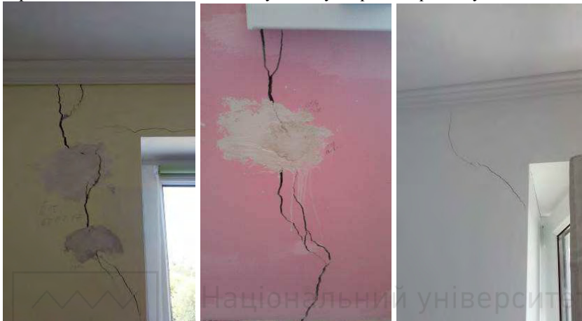
Фото. 3. Тріщини у зовнішніх несучих стінах будівлі
