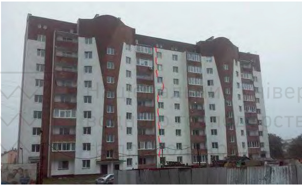
Фото. 1. Фасад будівлі з тріщинами на висоту поверхів
