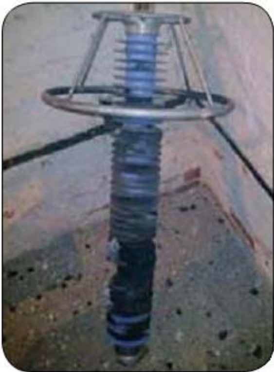
Рис. 1.9. Демонтований обмежувач перенапруг після пробою та вигорання ізоляції
