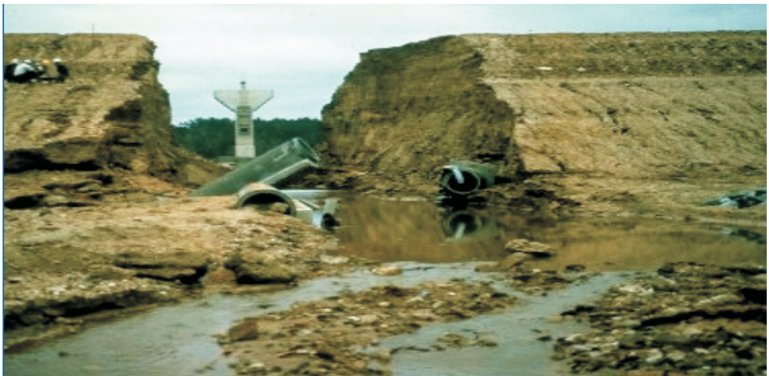
Рисунок 1.14 – Наслідки пошкодження водоводу у ґрунтовій греблі (104)
