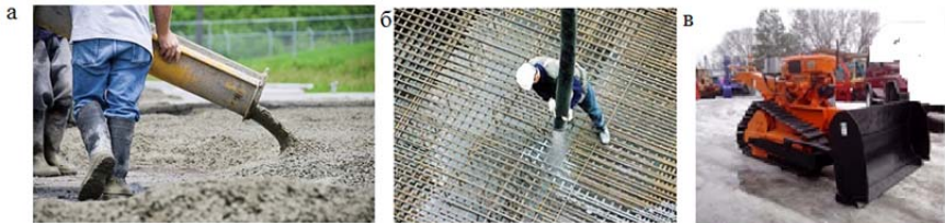
Рис. 3.54. Роподіл бетонної суміші у блоці бетонування: а – вібротоком; б – віброхоботом; в – мінірозрівнювачем
