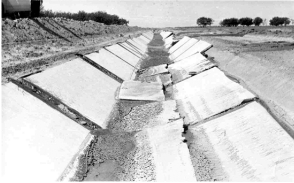
Рис. 1.37. Руйнування облицювання з залізобетонних плит при відсутності запличиків
