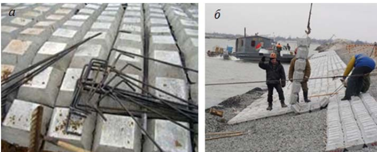
Рис. 2.13. Монтаж полотен із УГЗБМ: а – мати і Т-подібні скоби; б – монтаж матів
