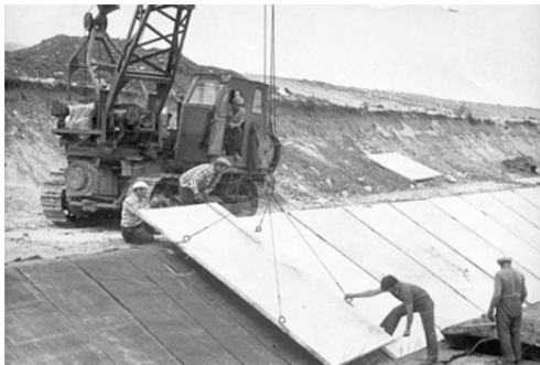
Рис. 1.34. Вкладання залізобетонних плит тракторним краном на укосу каналу з допомогою чотирьох гілкового стропу
