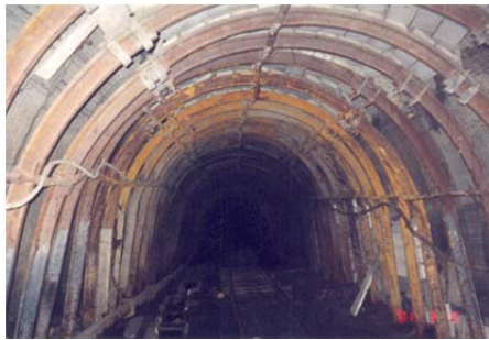
Рис. 3.84. Металеве арочне кріплення
