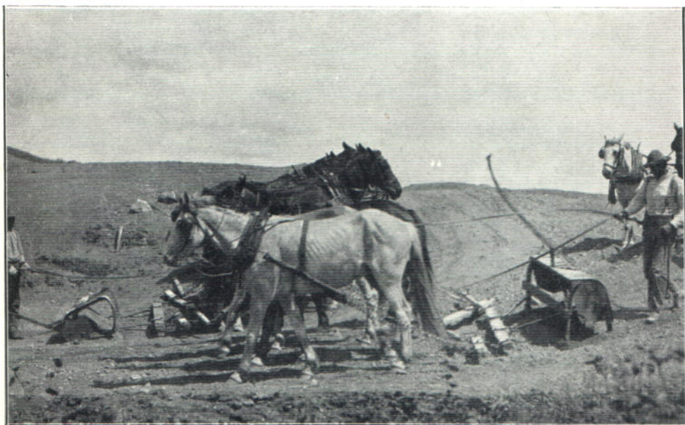
Фиг. 17. Предпріятіє рѣки Милкъ въ шт. Монтана. Прорытіе главнаго канала при помощи, такъ называемыхъ, фрезно-скреперовъ.
