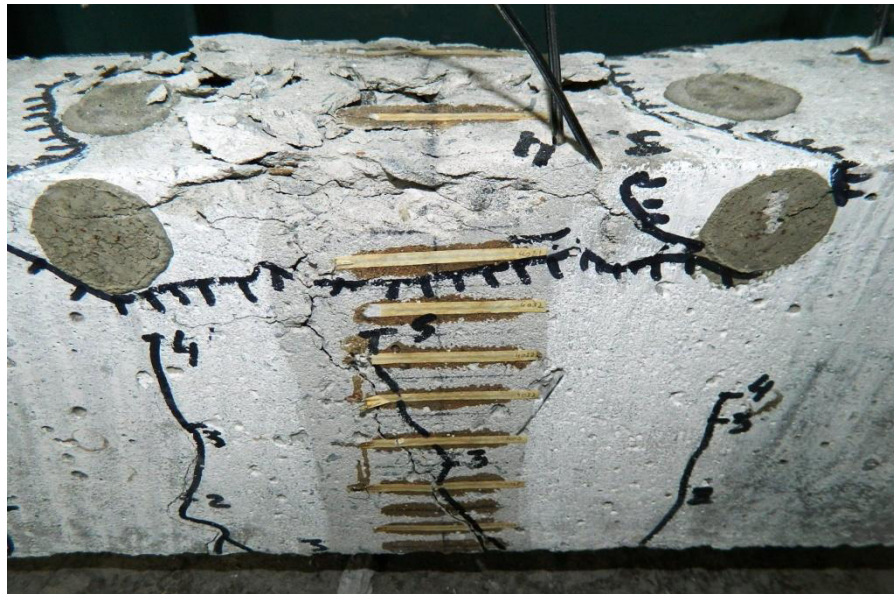
Рисунок 3.2 – Руйнування не підсиленої балки Б0-1 (руйнування лещадки бетону стиснутої зони)
