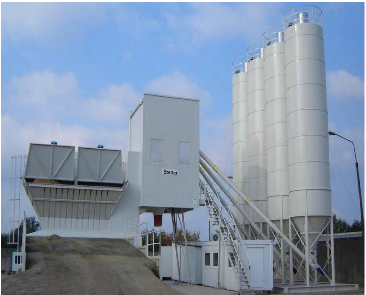
Рисунок 6.6 – Бетонозмішувальний вузол ППФ "Торгбуд сервіс"
