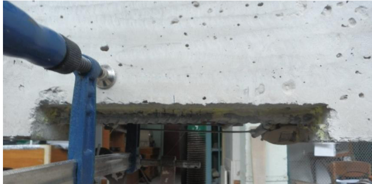
Рис. 2.10. Загальний вигляд порожнини в бетоні розтягнутої зони для доступу до робочої арматури
