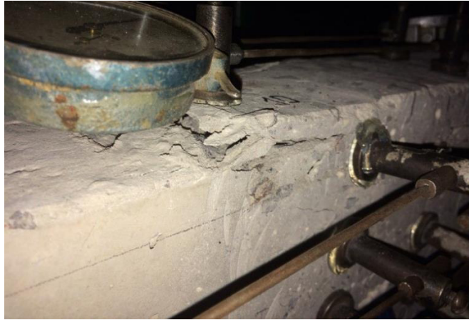
Рис. 3.2. Крихке руйнування бетону найбільш стиснутої фібри зразка КБ-1.1
