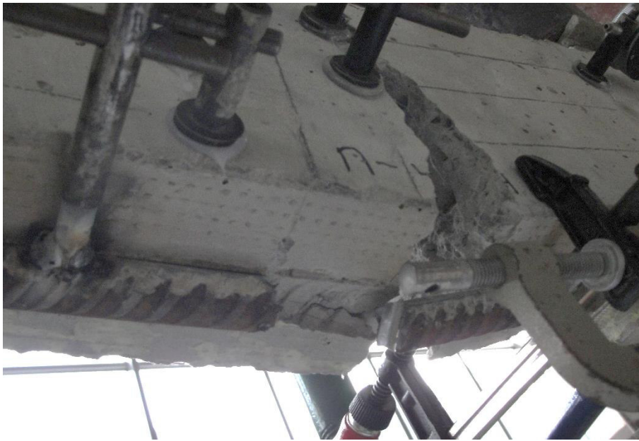
Рис. 3.9. Руйнування зразка БП-1.7-0.5, внаслідок розриву робочої арматури
