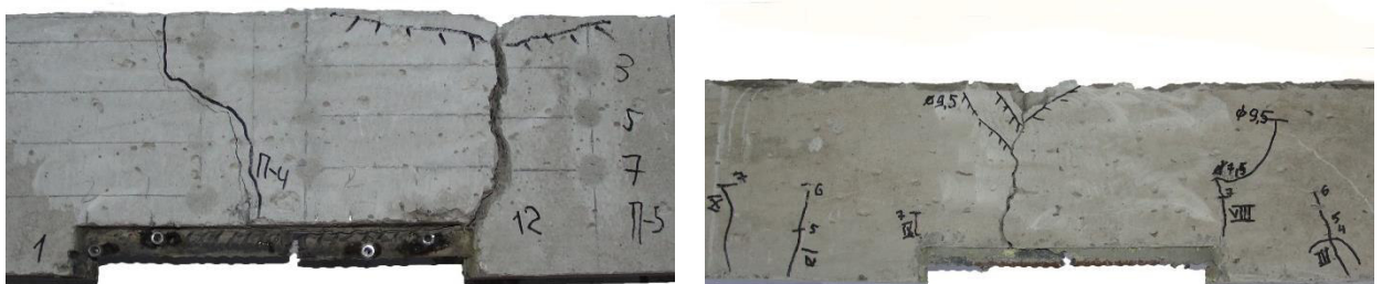
Рис. 3.35. Характер утворення тріщин центрального перерізу дослідного зразка БП-1.5-0.3 (зліва) та БП-1.6-0.3 (справа)
