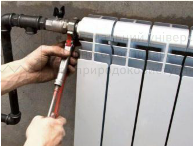
Рис.2.6. Приєднання опалювального приладу до мережі
