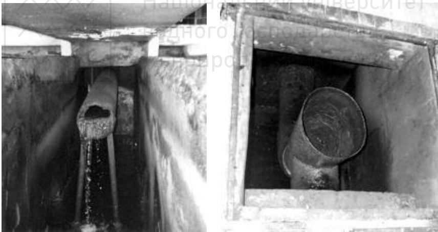
Рис. 3.5. Трубопровід подачі води на фільтр та аератор
