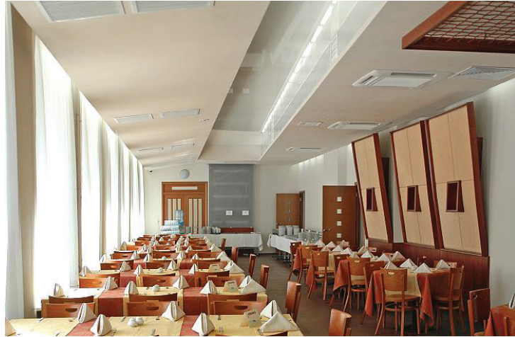
Рис. 7.2. Зовнішній вигляд системи вентиляції залу для відвідувачів
