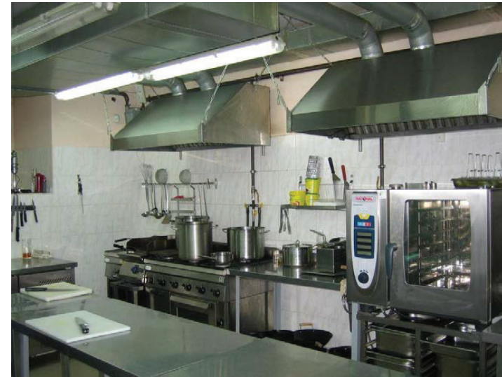
Рис. 7.1. Зовнішній вигляд системи вентиляції кухні (гарячого цеху)
