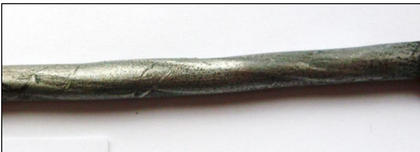
Рис. 2.14. Корозія арматури в зразках сульфатно-шлакового в'язучого (фосфогіпс – 5%), добавкою Melflux (0,4%), що зберігались у воді
