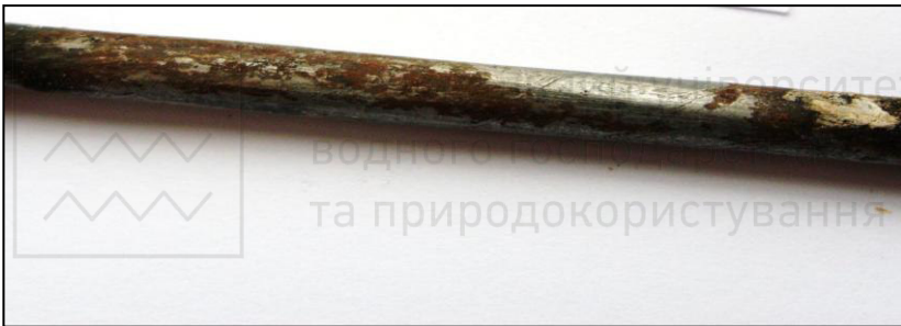
Рис. 2.13. Корозія арматури в зразках сульфатно-шлакового в'язучого (фосфогіпс – 10%), без добавок, що зберігались у воді
