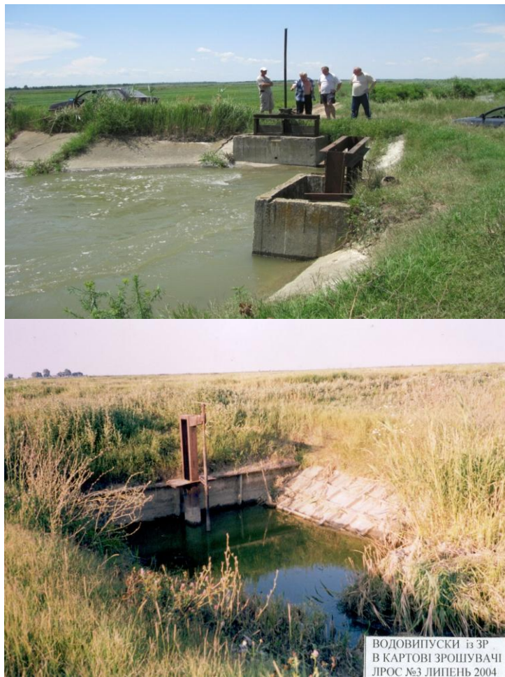
Рис. 2.13. Вододільний вузол на каналі 1МК та водовипуск в картовий зрошувач Лісковської РЗС
