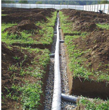
Рис. 5. Дренажний колектор (світлина взята з сайту https://моссептик.рф/catalog/drenazh/drenazh-uchastka/ )
