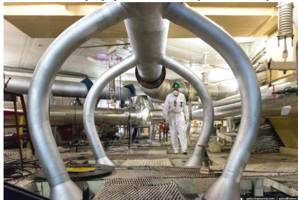
Рис. 11. Паропровід-збирач на Балаківській АЕС – найпотужнішій атомній електричній станції Росії (світлину С. Степанова взято з сайту http://rblogger.ru/2015/10/16/balakovskaya-aes/ )
