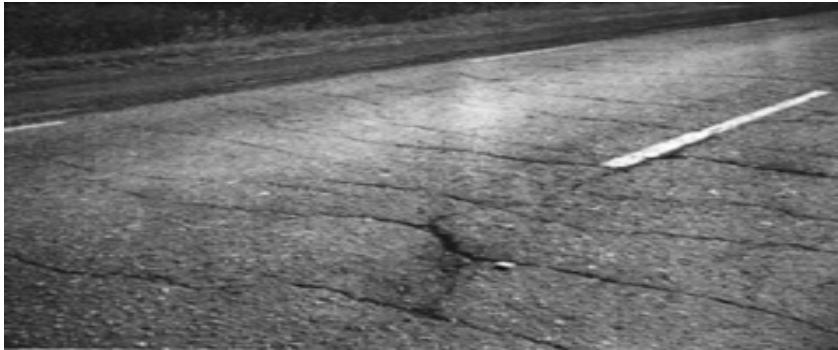
Рис. 1. Існуючі деформації та дефекти на ділянці автомобільної дороги Н-25 на ділянці км 175+950 – км 178+000
