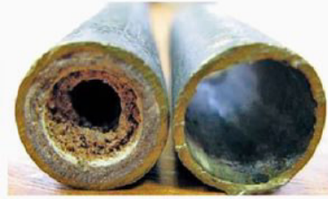
Рис. 1. Результат утворення відкладень на ТС котлів. Ліве фото, трубка після 4-х опалювальних сезонів, праве – після хімічної очистки при підготовці до нового сезону
