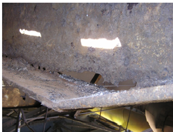
Рис. 7. Наскрізна корозія стінки поперечної балки на консолях
