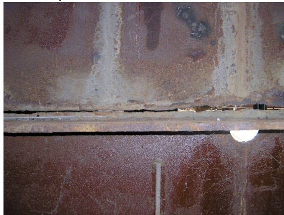
Рис. 6. Наскрізна корозія стінки поперечної балки над опорною діафрагмою головної балки
