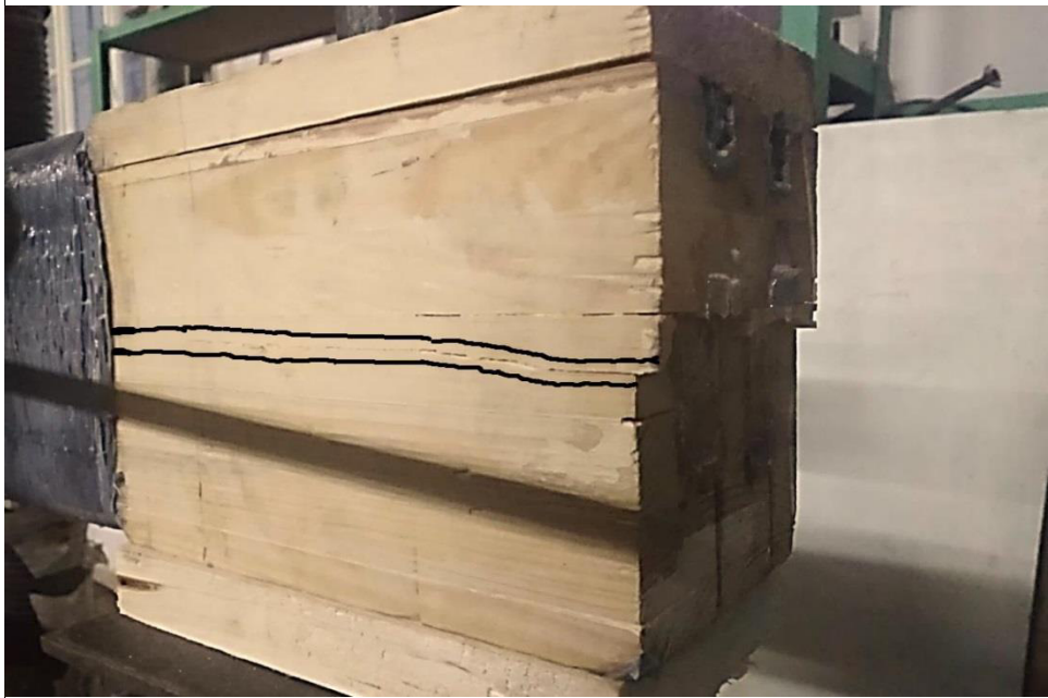
Рис. 4.15. Характер руйнування балки БКА-12Б
