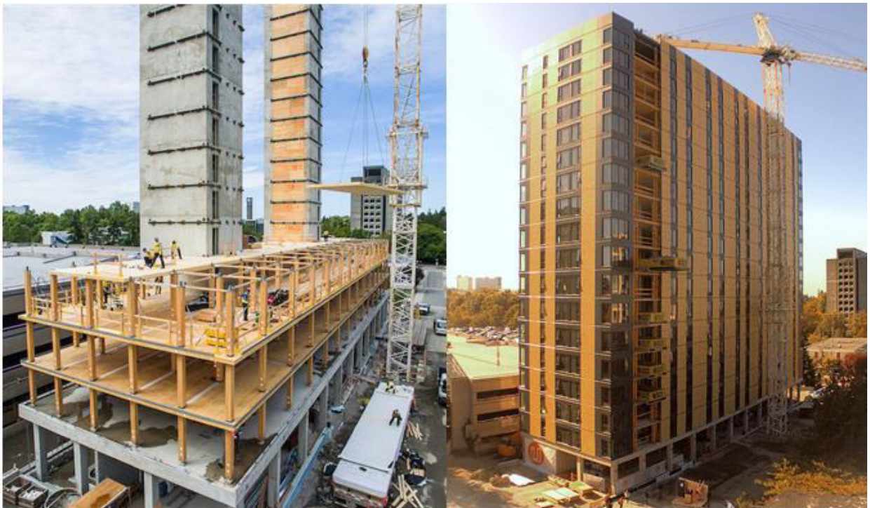
Рис. 1.13. «Brock Commons Tallwood House» м. Ванкувер, Канада
