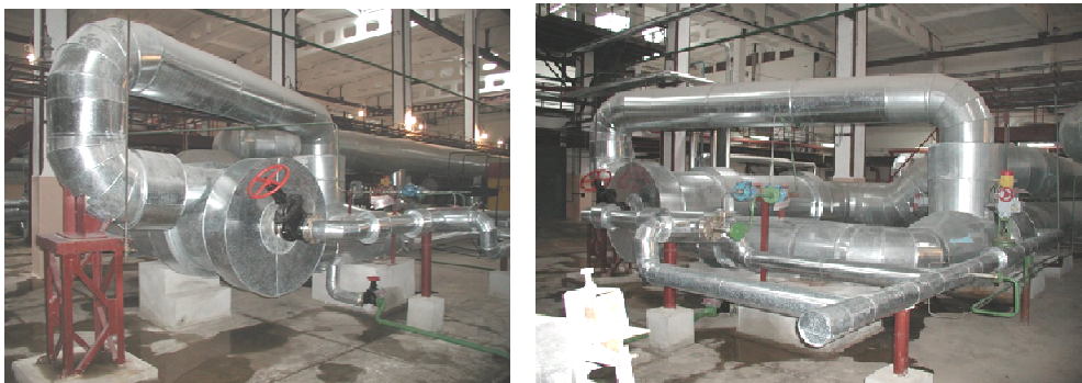
Рис. 6. Змішувачі кислоти СОДВ. Лінія зневоднення шламу споруд очищення добавленої води
