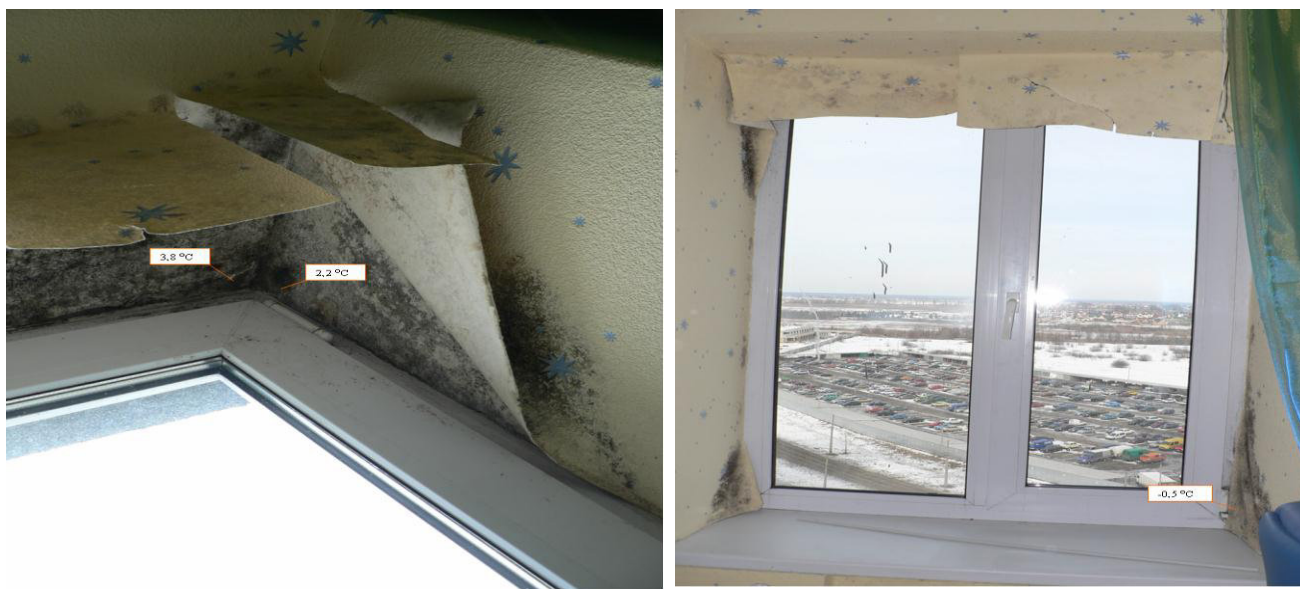
Рис. 4.6. Негативний вплив заміни віконних конструкцій на тепловологісний режим приміщень і зовнішніх огорожень
