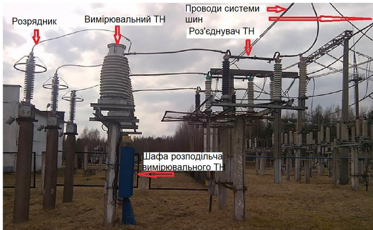
Рисунок 5.9 – Розташування вимірювальних трансформаторів напруги на підстанції 110 кВ
