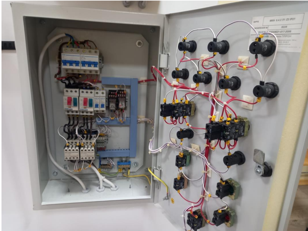
Рисунок 7.3 – Електрична шафи керування двигунами
