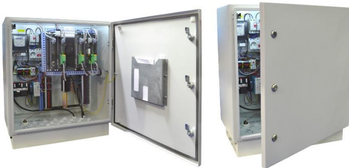
Рис. 8. Дорожні контролери (ДК), (28)
