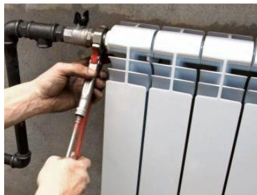
Рис. 32. Приєднання опалювального приладу до мережі
