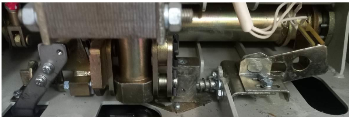
Рисунок 2.22 – Натиснуте положення SAB, має місце в робочому та контрольному положенні висувного елемента, контакти замкнені, що дозволяє ввімкнути вимикач
