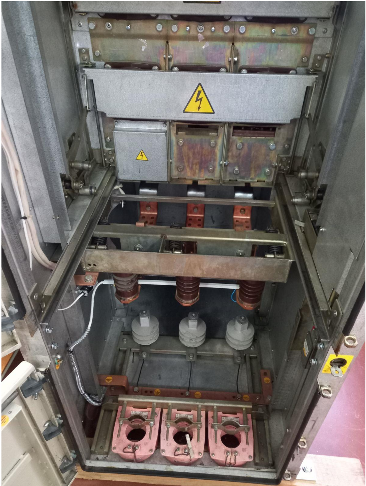
Рисунок 1.13 – Внутрішній об'єм шафи в лабораторних умовах після демонтажу перегородки та двох кришок контактів вторинних кіл трансформатора струму
