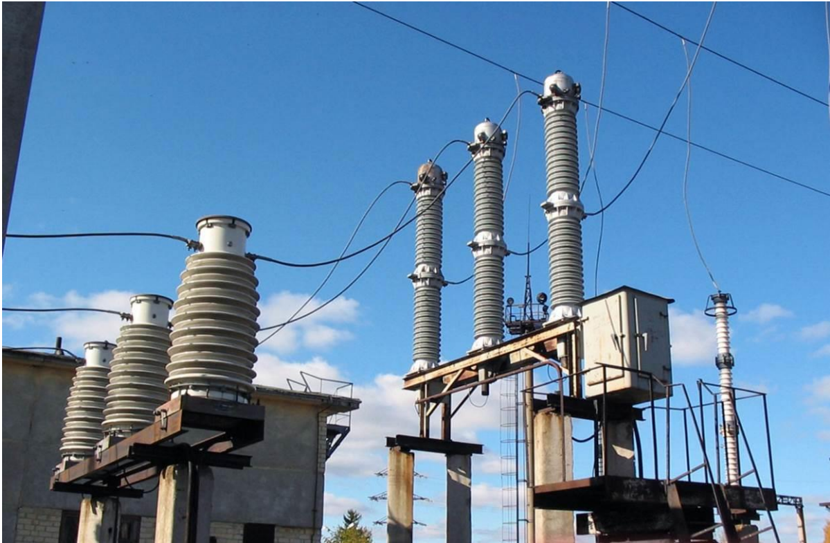
Рисунок 5.10 – Розташування вимірювальних трансформаторів струму типу ТФЗМ-110
