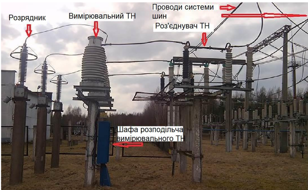
Рисунок 5.9 – Розташування вимірювальних трансформаторів напруги на підстанції 110 кВ
