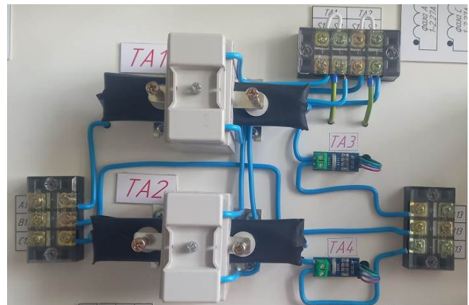
Рис. 2.6. Вимірювальні трансформатори струму ТА1, ТА2
