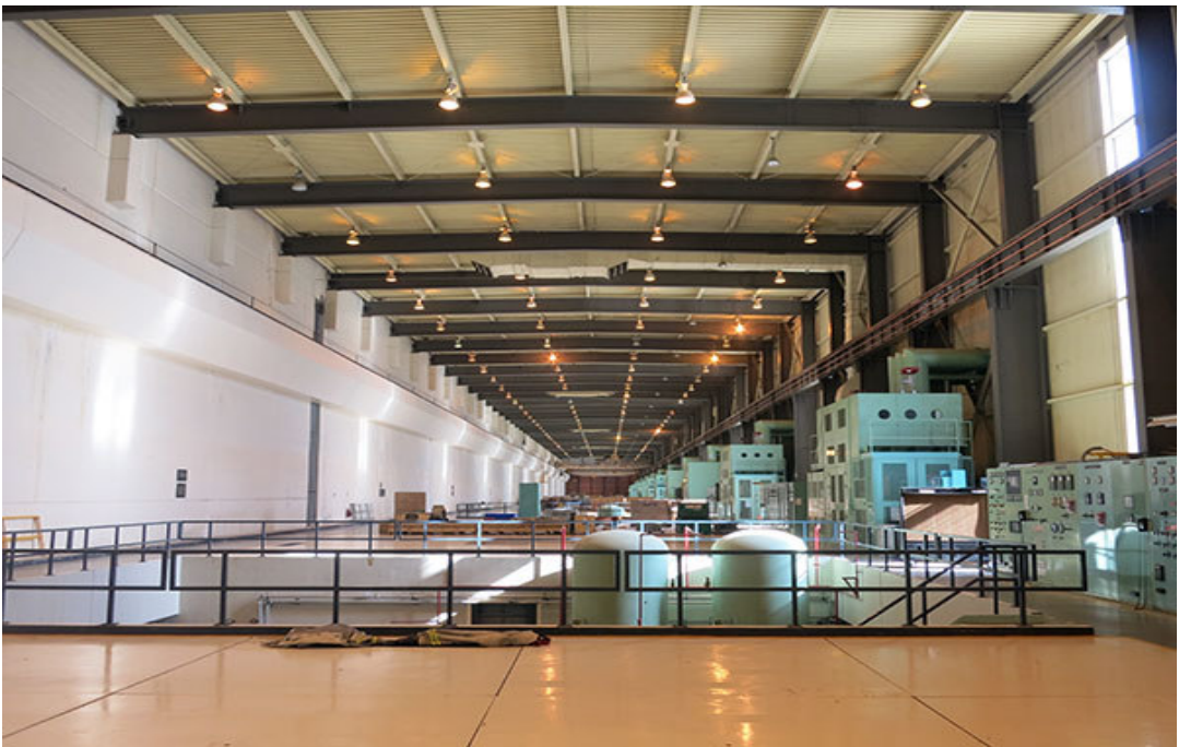
Рис. 2.24. ГЭС Кеттл: машина зала
