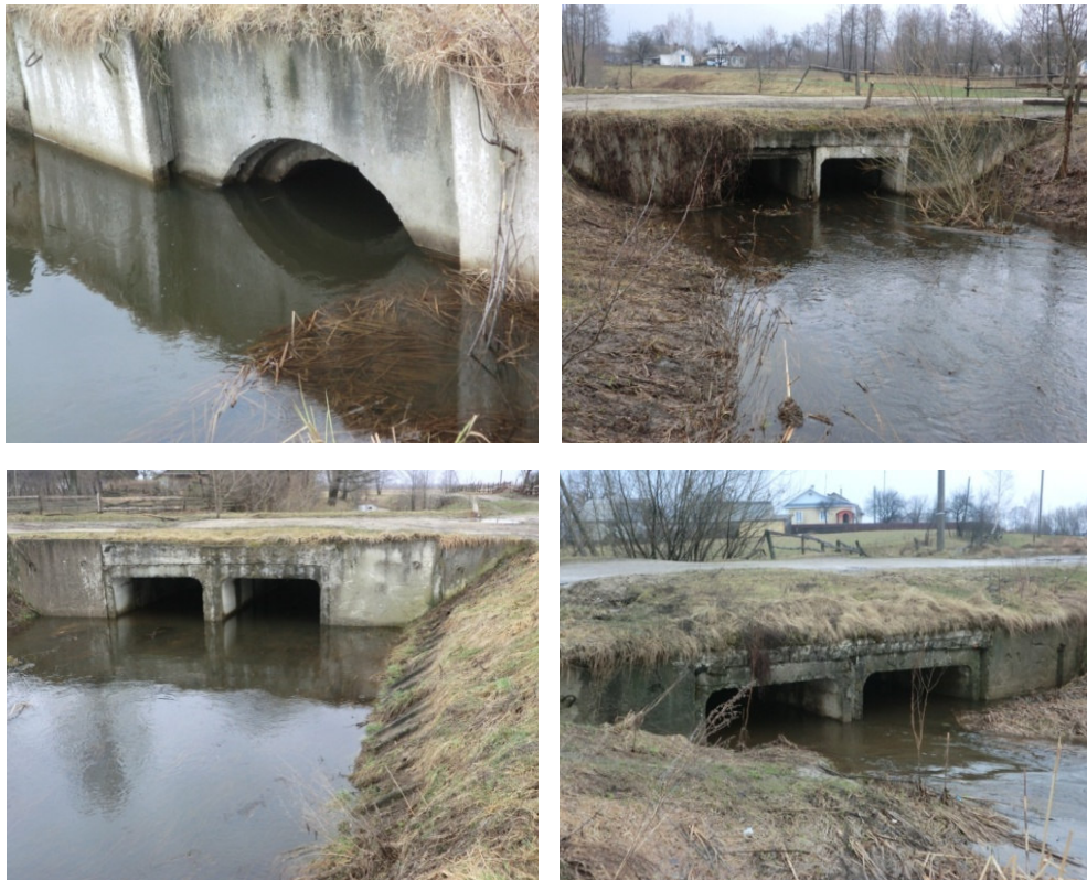
Рис. 6.5. Переїзди, в яких спостерігаються перекіс, лущення бетону, замулення, проростання трави та підмив споруди
