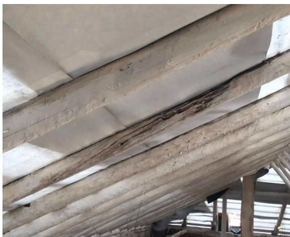
Рис. 4. Пліснява і пошкодження внутрішньої обробки
