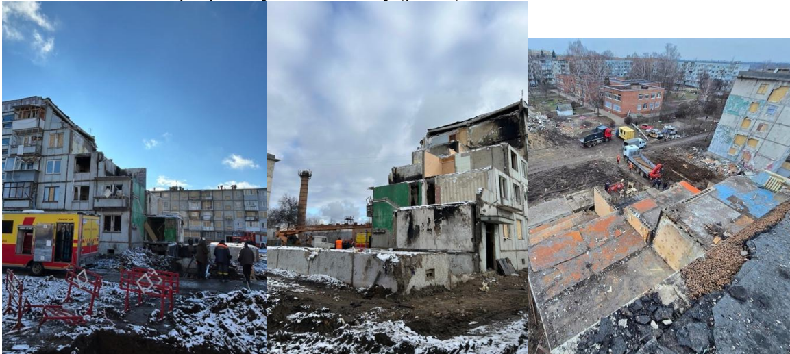
Рис. 1. Уражений ракетою будинок по вул. Баленка, 7
