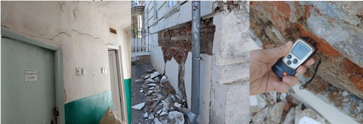
Рис. 1. Деформація перегородок Рис. 2. Відшарування штукатурки Рис. 3. Вимірювання вологості
