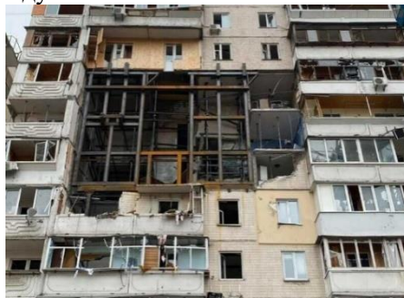
Рис. 1. Ушкодження конструкцій внаслідок влучення снарядів, та початок їх відновлення
