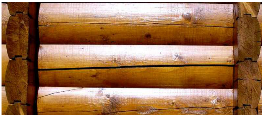
Дефекти брусів несучих стін у вигляді поздовжніх тріщин, викликаних усушкою матеріалу (с. Світязь Волинської області, будинок відпочинку)
