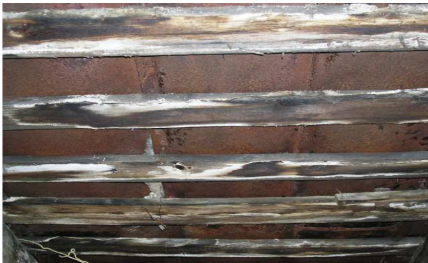
Суцільна іржа на нижній поверхні покрівельної бляхи внаслідок систематичного утворення водяного конденсату (м. Рівне, житловий будинок)
