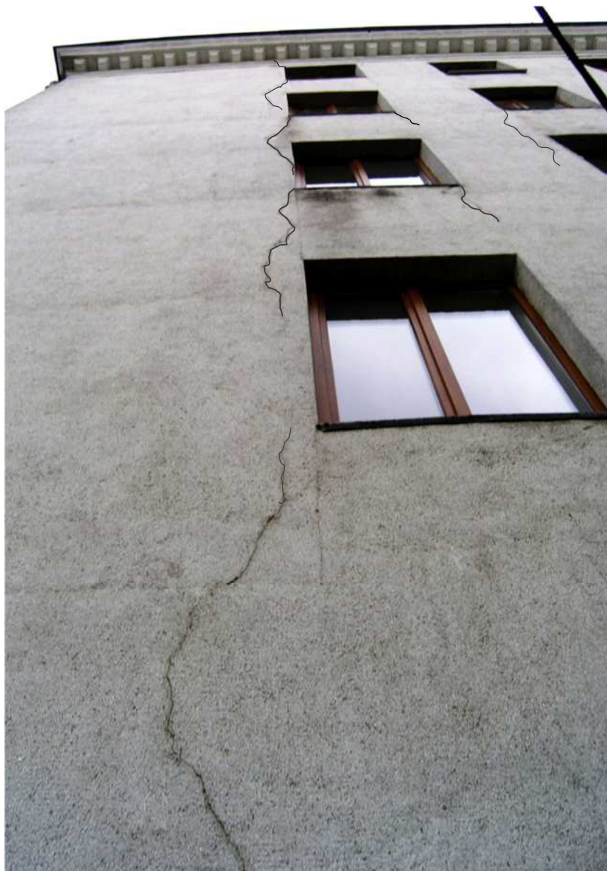
Фото 2.10. Масові силові вертикальні тріщини у зовнішніх несучих та самонесучих стінах
