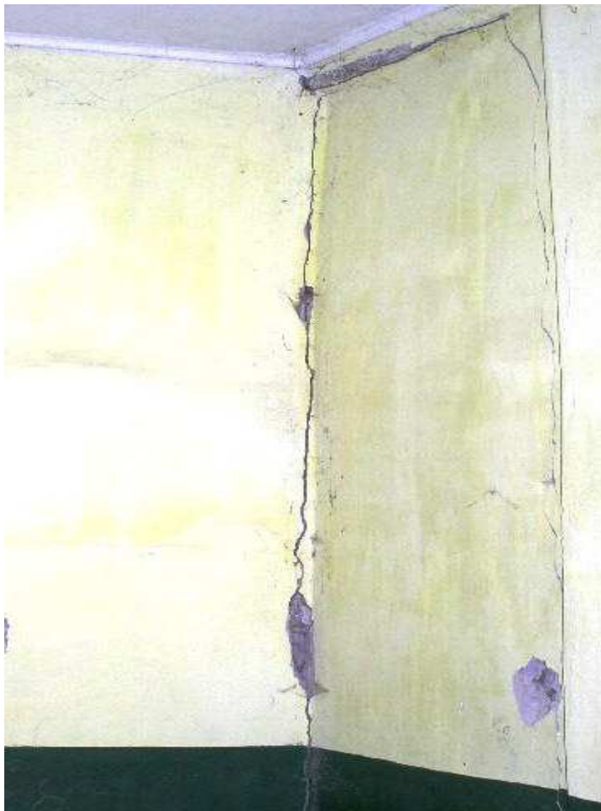
Вертикальна наскрізна тріщина в зоні примикання зовнішньої і внутрішньої стін внаслідок відсутності перев'язки кладки і різниці навантажень на стіни (м. Новоград-Волинський Житомирської обл., житловий будинок)
