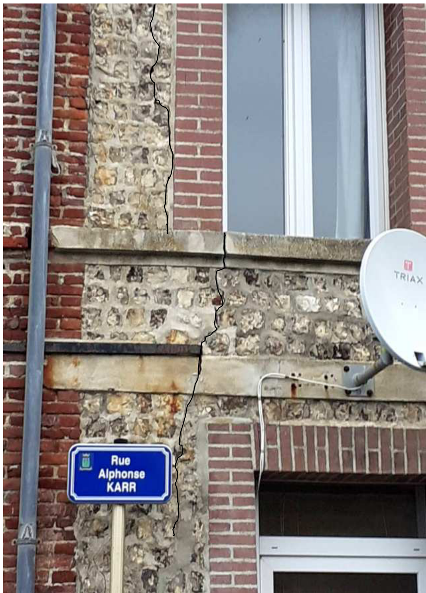
Силовая наскрізна тріщина в несучій стіні внаслідок нерівномірного осідання фундаменту (м. Антоні, Франція, житловий будинок)
