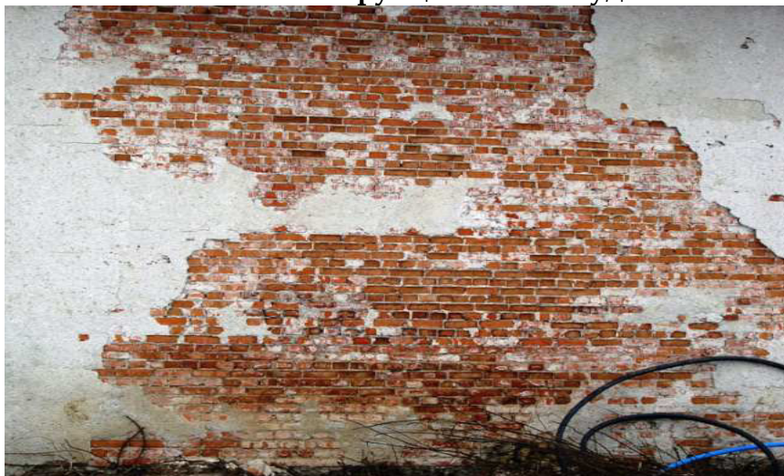
Вивітрювання цегляної кладки зовнішньої стіни внаслідок циклічного впливу «замокання-заморожування-відтаювання» (с. Нижнє Солотвино Ужгородського району, поліклінічний корпус санаторію)
