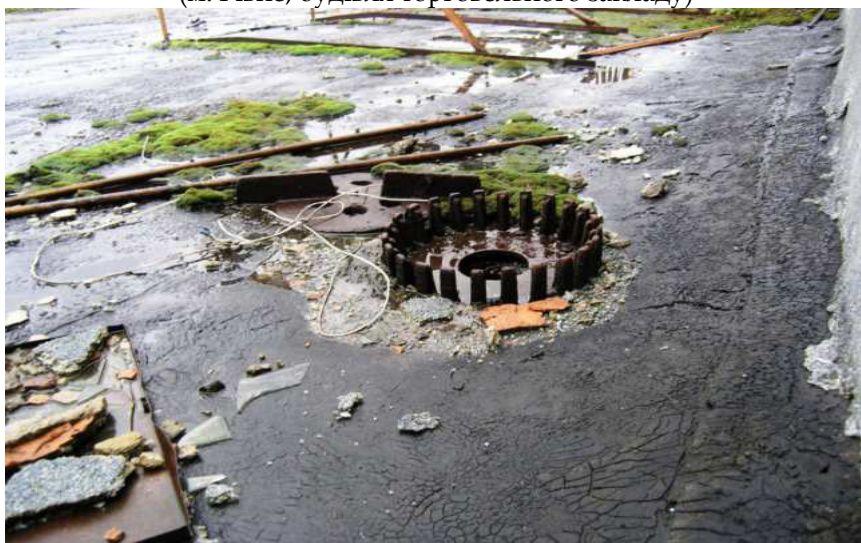
Протікання рулонної покрівлі внаслідок технологічного дефекту водоприймальної лійки (м. Дубно Рівненської обл., будівля кінотеатру)
