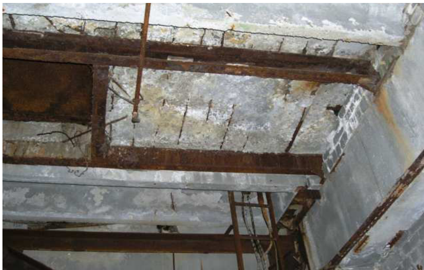
Корозія металевих елементів підсилення перекриття внаслідок відсутності антикорозійного покриття (м. Рівне, завод мінеральних добрив)
