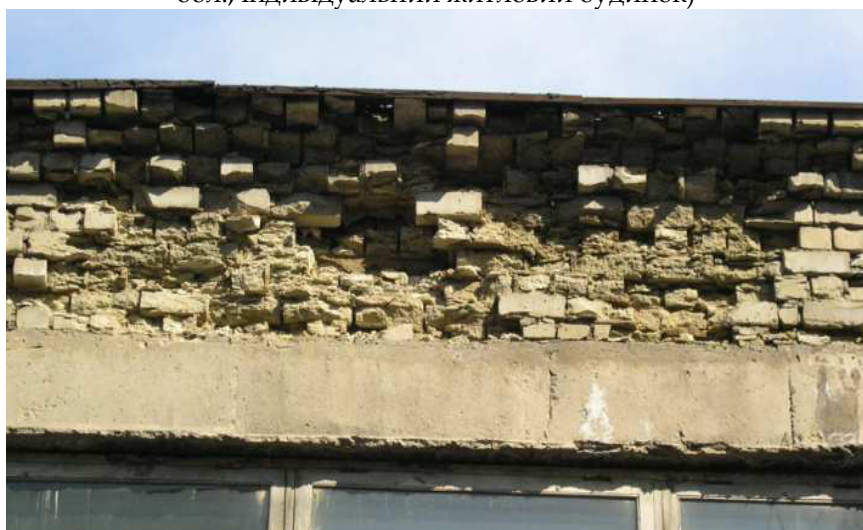
Руйнування карнизної частини даху внаслідок використання цегли низької марки (м. Житомир, виробнича будівля)
