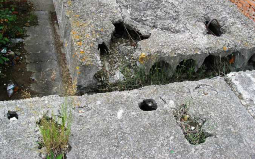
Руйнування опорної частини збірної залізобетонної плити перекриття внаслідок заводського браку (м. Острого Рівненської обл., житловий будинок)
