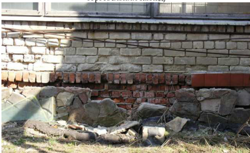
Руйнування облицювання цоколя внаслідок замокання поверхневими водами (м. Рівне, промислова будівля)
