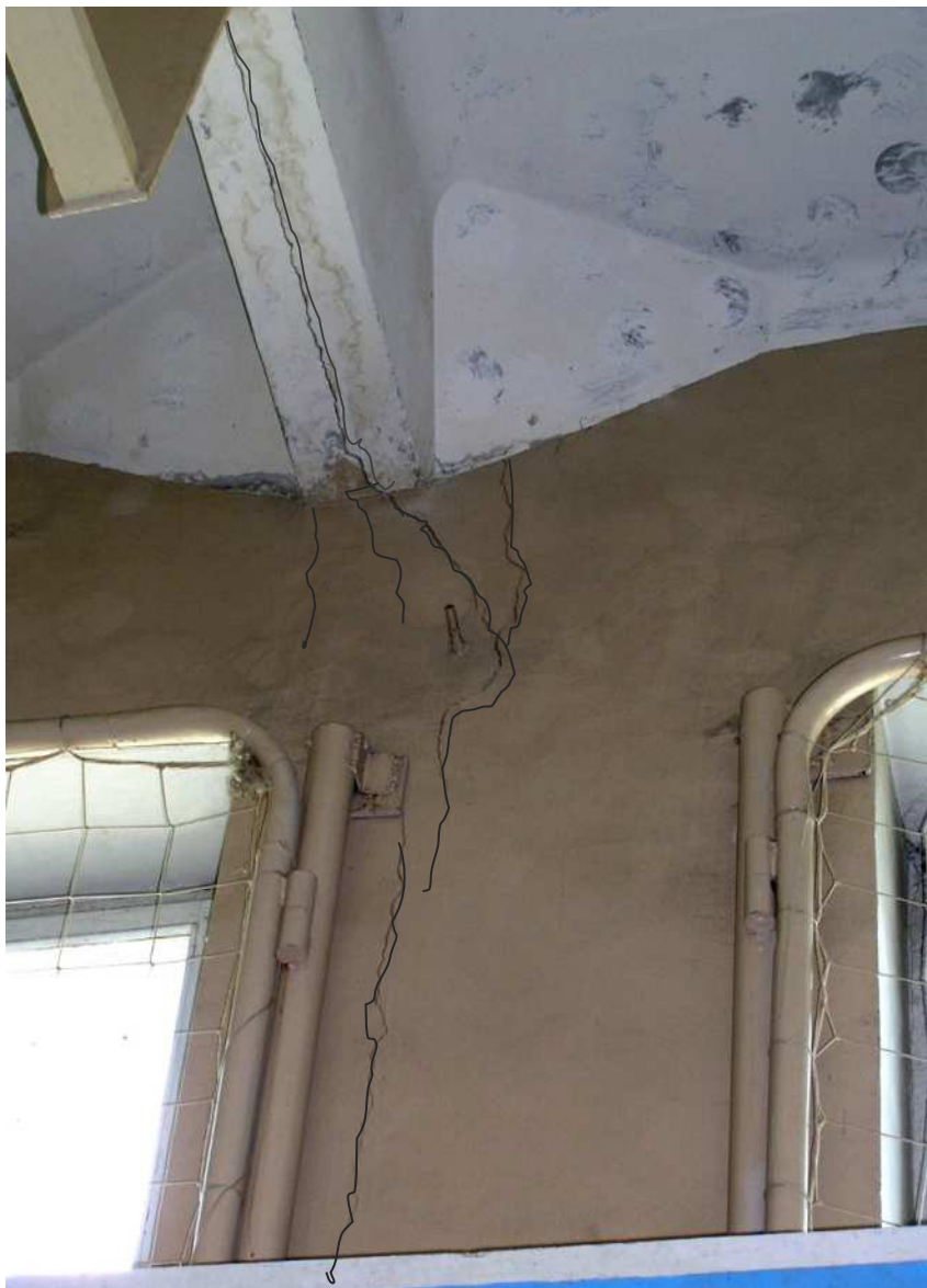
Руйнування кладки під опорною частиною плити покриття внаслідок перенавантаження простінка (м. Нетішин Хмельницької обл., будівля загальноосвітньої школи)
