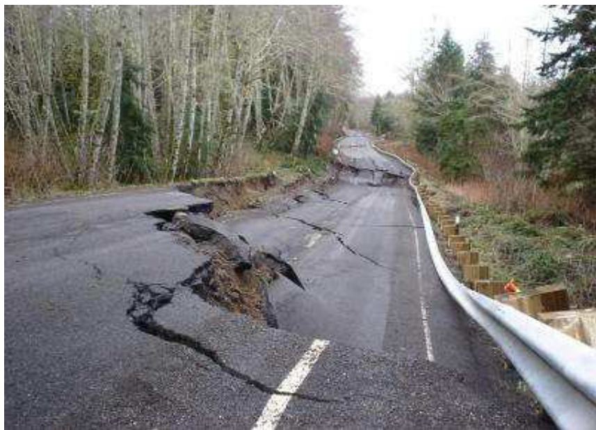
Фото 1.16. Зсув дороги з асфальтобетонним покриттям
