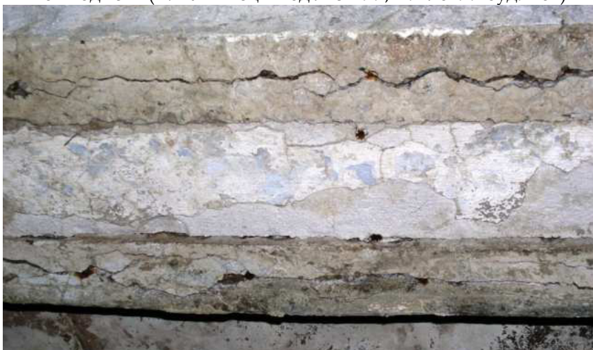
Випинання захисного шару бетону збірної залізобетонної плити внаслідок корозії робочої арматури (м. Львів, промислова будівля)
