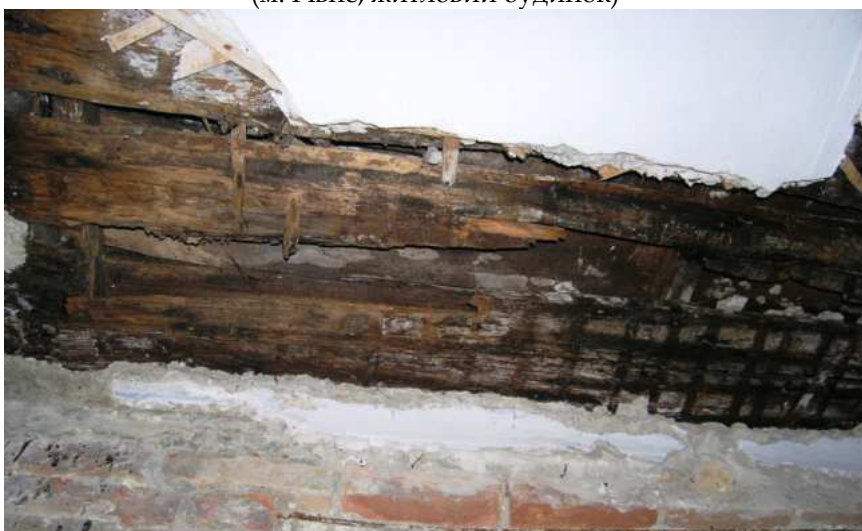
Пошкодження гнилизною дерев'яного горіщного перекриття внаслідок систематичного замочування водою з покрівлі і даху (Рівненський р-н, індивідуальний житловий будинок)
