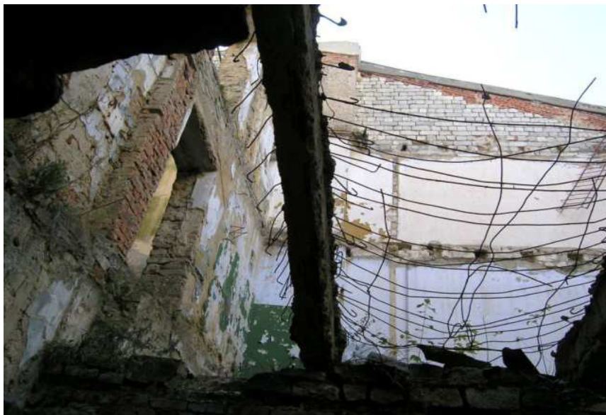
Аварія монолітного залізобетонного перекриття внаслідок механічних пошкоджень (м. Кам'янець-Подільський, житловий будинок)
