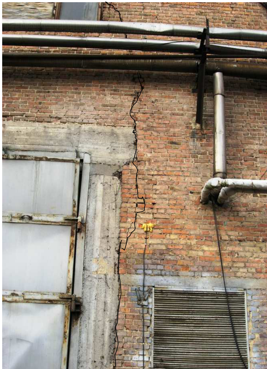
Вертикальна силова тріщина у зовнішній стіні внаслідок нерівномірних навантажень на суміжні ділянки (м. Рівне, виробничий корпус)
