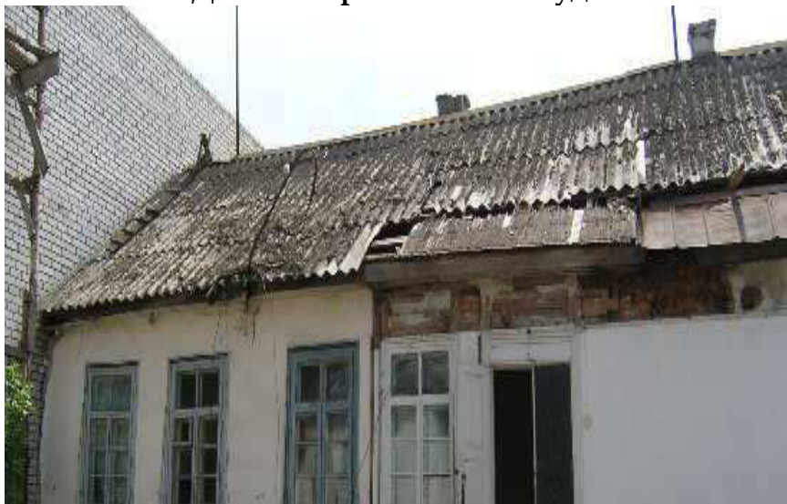
Руйнування шиферної покрівлі внаслідок фізичного зношування та механічних пошкоджень (м. Новоград-Волинський Житомирської обл., індивідуальний житловий будинок)
