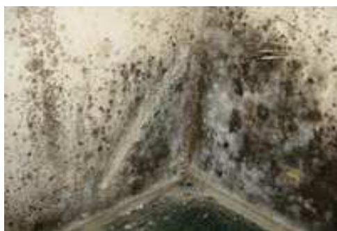
Ураження стін ФПЧ цвільлю внаслідок просочування інфільтраційної вологи. (Матеріали будівельної компанії «КМП», м. Львів)
