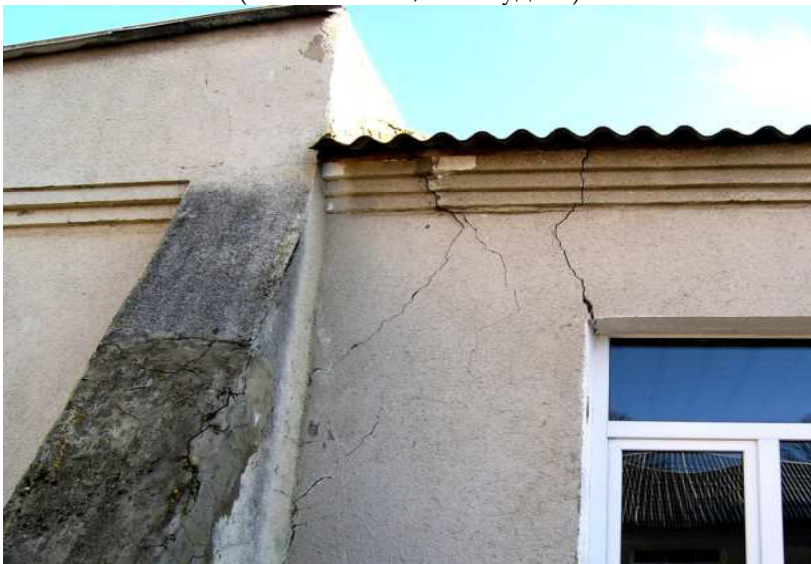
Силкові наскрізні тріщини в несучій стіні внаслідок добудови без вертикального деформаційного шва (Рівненська обл., загальноосвітня школа)
