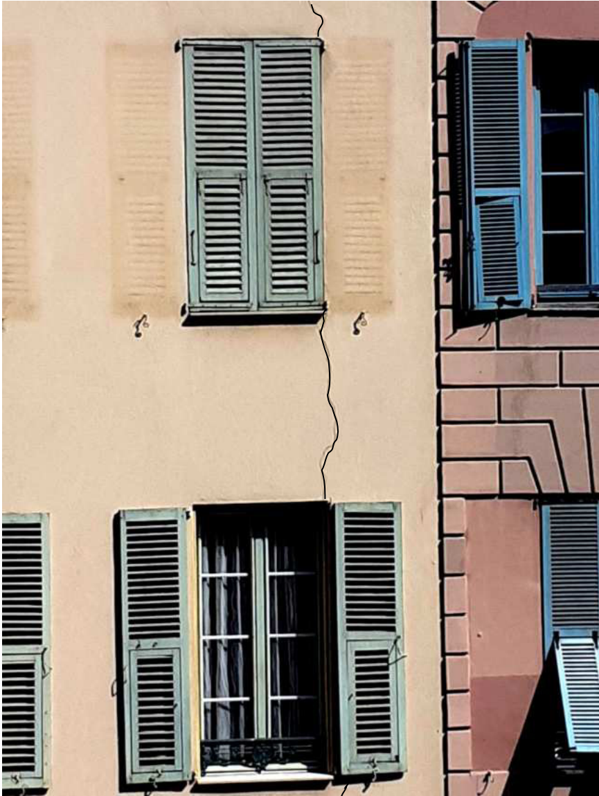
Силві наскрізні тріщини в несучій стіні внаслідок донавантаження фундаменту сусідньою добудовою (м. Антоні, Франція, житловий будинок)
