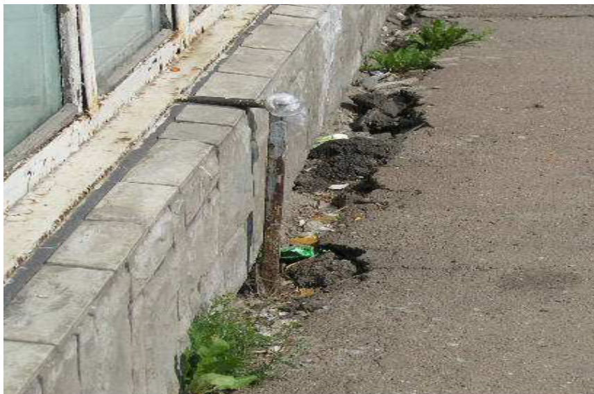
Руйнування асфальтобетонної відмостки внаслідок просідання ґрунтової основи вимощення (м. Львів, вбудовано-прибудований торговельний заклад)
