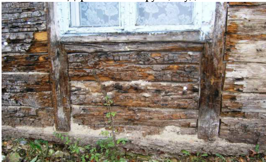
Руйнування зовнішньої стіни внаслідок ураження деревини гнилизною (м. Острог Рівненської обл., будівля школи-інтернату)
