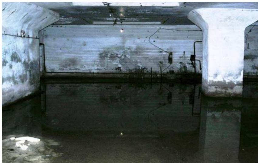
Наявність води у фундаментно-підвальної частині будівлі внаслідок відсутності вертикальної гідроізоляції стін та горизонтальної гідроізоляції підлоги (м. Рівне, будинок побуту)
