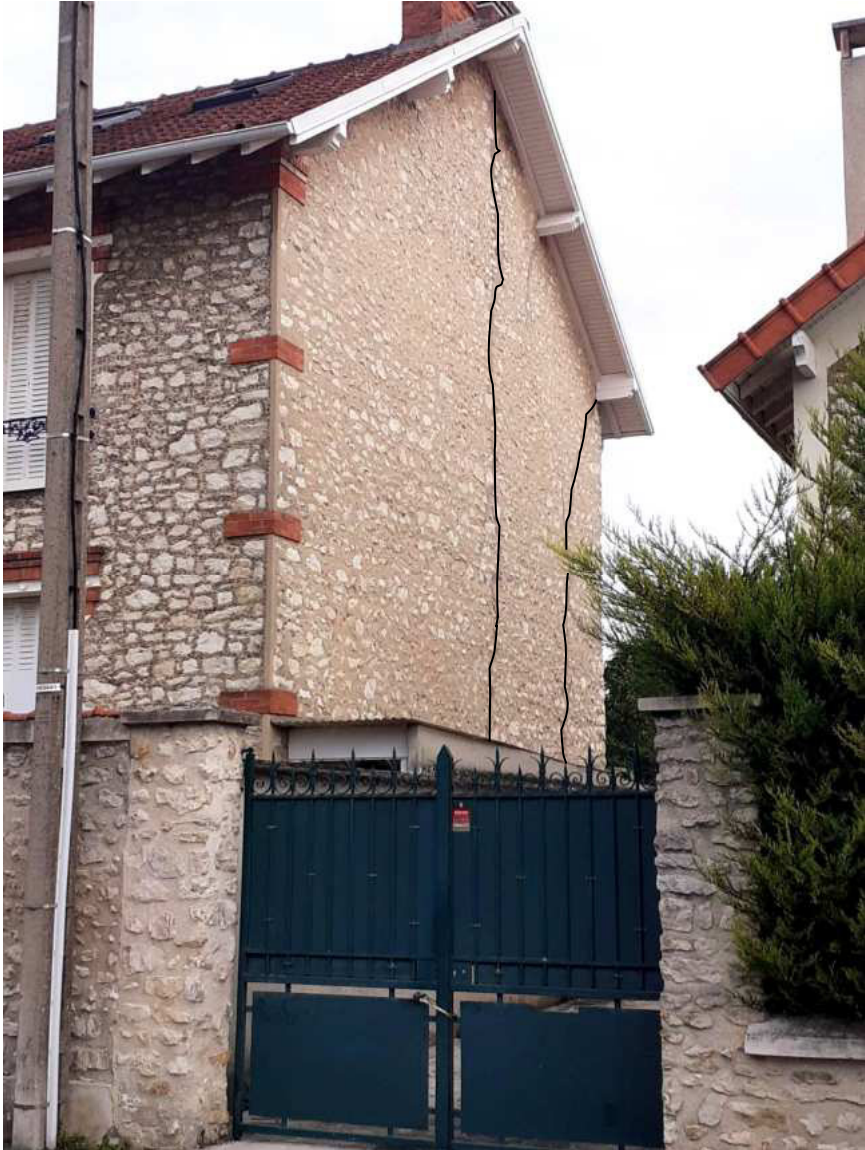
Силкові наскрізні осадочні тріщини в самонесучій стіні внаслідок нерівномірності навантажень і недостатній перев'язці кладки (м. Антоні, Франція, житловий будинок)
