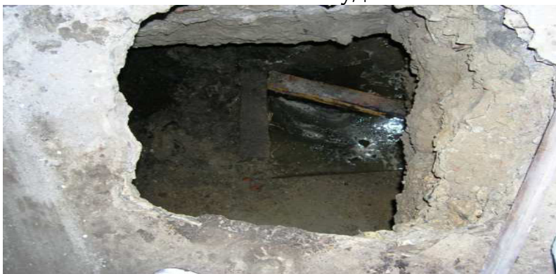
Карстова порожнина під підлогою фундаментно-підвальної частини (ФПЧ), утворена внаслідок механічної суфозії (м. Львів, універмаг на пл. Ринок)
