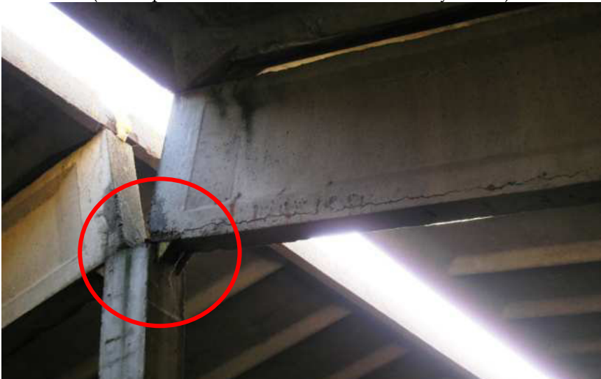
Аварійний стан збірного залізобетонного каркасу внаслідок недостатньої глибини обпирання балки покриття (сільськогосподарська будівля, с. Радів Рівненського району)
