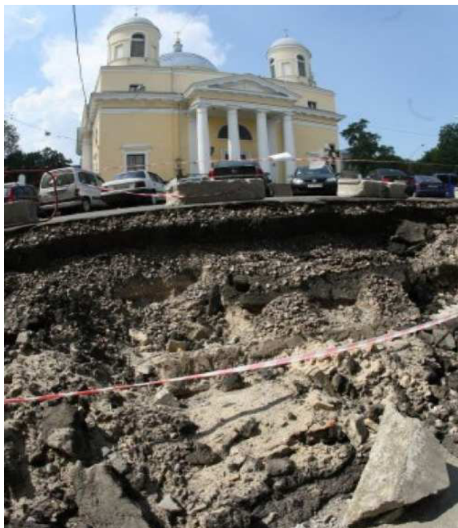
Фото 1.13. Зсув, спричинений витоками з водонесучих підземних комункацій. м. Київ
