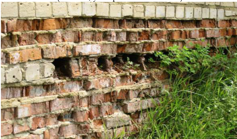
Руйнування цегляної кладки цоколя внаслідок циклічного впливу «замокання капілярною вологою-замерзання-відтаювання» (м. Острог Рівненської обл., житловий будинок)
