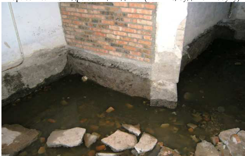
Наявність води у фундаментно-підвальної частині будівлі внаслідок відсутності вертикальної гідроізоляції стін та відсутності підлоги (м. Рівне, житловий будинок)
