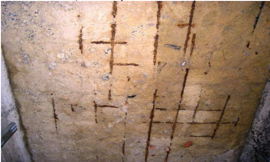
Руйнування монолітного залізобетонного перекриття внаслідок використання бетону низької марки (м. Рівне, будівля підприємства громадського харчування)
