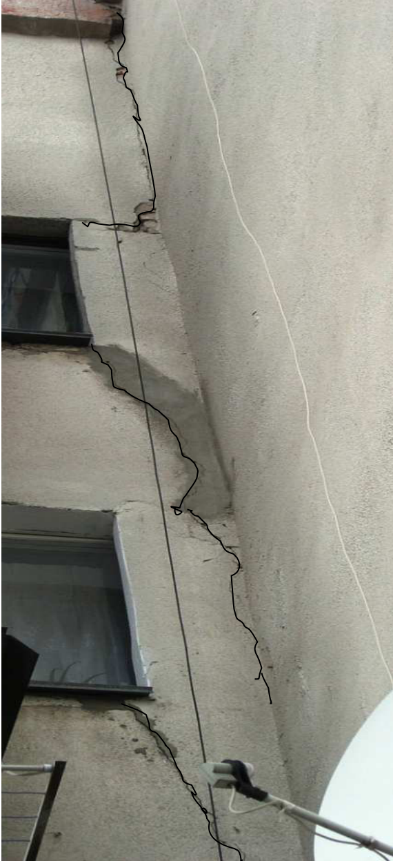
Вертикальна силова наскрізна тріщина в несучій стіні будинку внаслідок відсутності вертикального деформаційного шва між блок-секціями (м. Сарни Рівненської області, житловий будинок)
