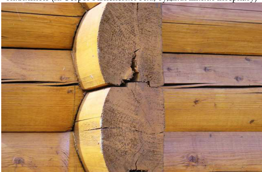
Дефект кутової частини стіни у вигляді тріщин у врубці (с. Світазь Волинської області, будинок відпочинку)
