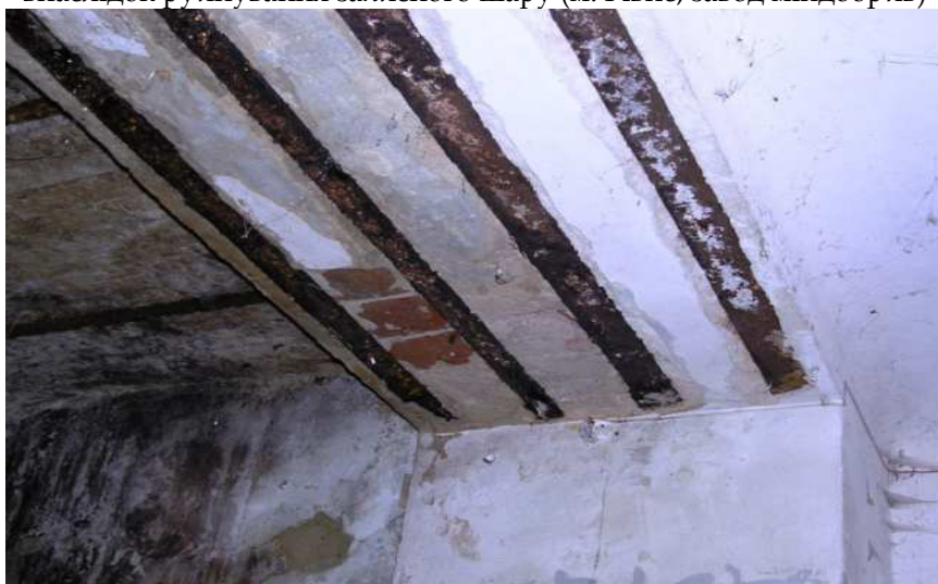
Корозія елементів армування ригеля перекриття внаслідок підвищеної вологості повітря приміщень (м. Львів, універмаг на пл. Ринок)
