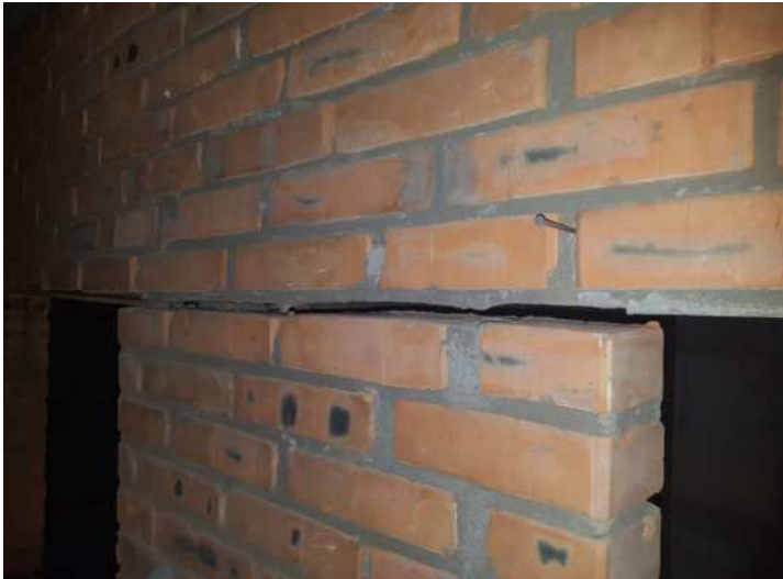
Горизонтальна осадочна тріщина в перегородці внаслідок відсутності фундаменту і осідання ґрунтової основи (Київська обл., новобудова)
