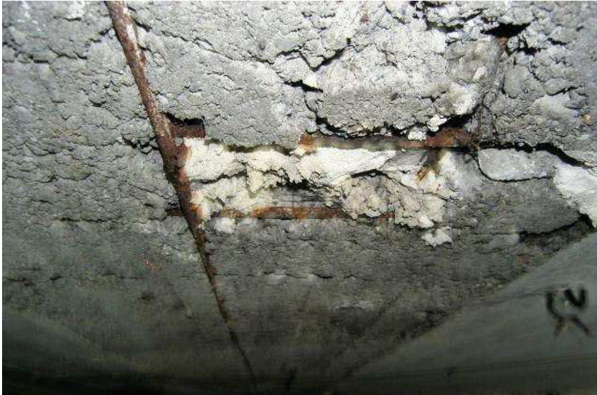
Оголення робочої арматури монолітного залізобетонного перекриття внаслідок технологічного браку (м. Львів, торговельний заклад)
