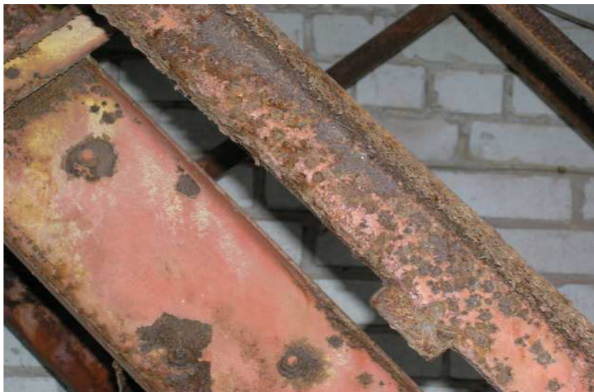
Суцільна поверхнева корозія металевого несучого елемента внаслідок руйнування захисного шару (м. Рівне, завод міндобрив)
