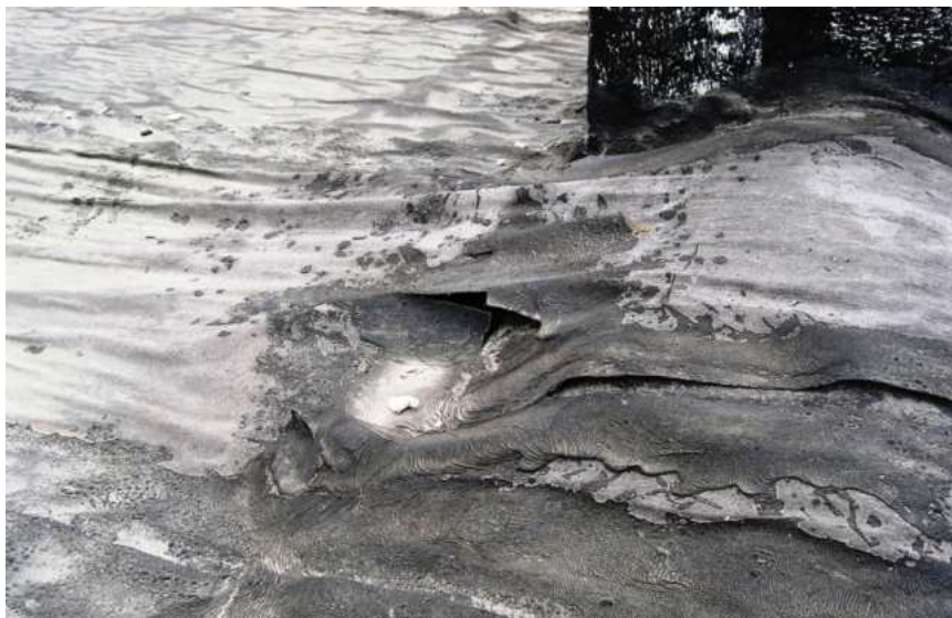
Пошкодження рулонної покрівлі внаслідок здуття і тріщин (м. Рівне, будівля торговельного закладу)
