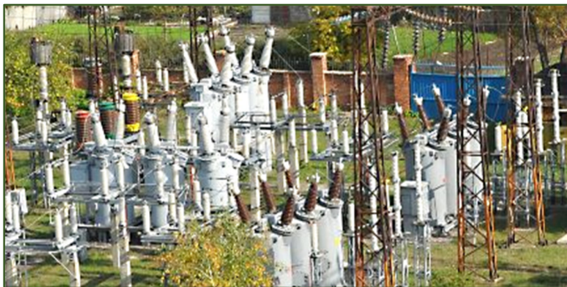
Рис. 6.5. Загальний вигляд головної понижувальної підстанції
