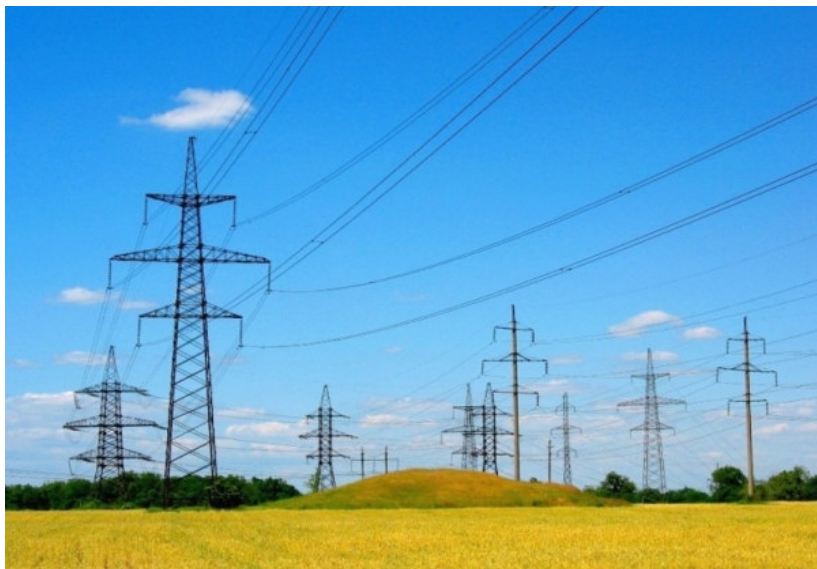
Рис. 6.2. Високовольтні лінії електропередачі (ЛЕП)
