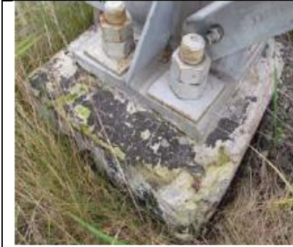
Рис. 10. Пошкодження гідроізоляції фундаменту
