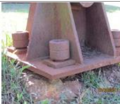
Рис. 12. Руйнування бетону фундаменту
