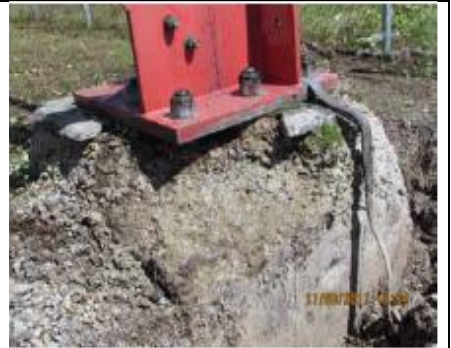
Рис. 11. Руйнування бетону фундаменту
