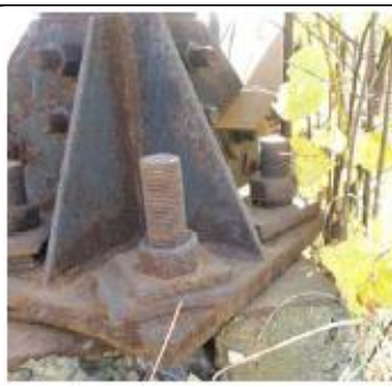
Рис. 13. Відсутність контргайок, гайки не затягнуті, корозія елементів з'єднання
