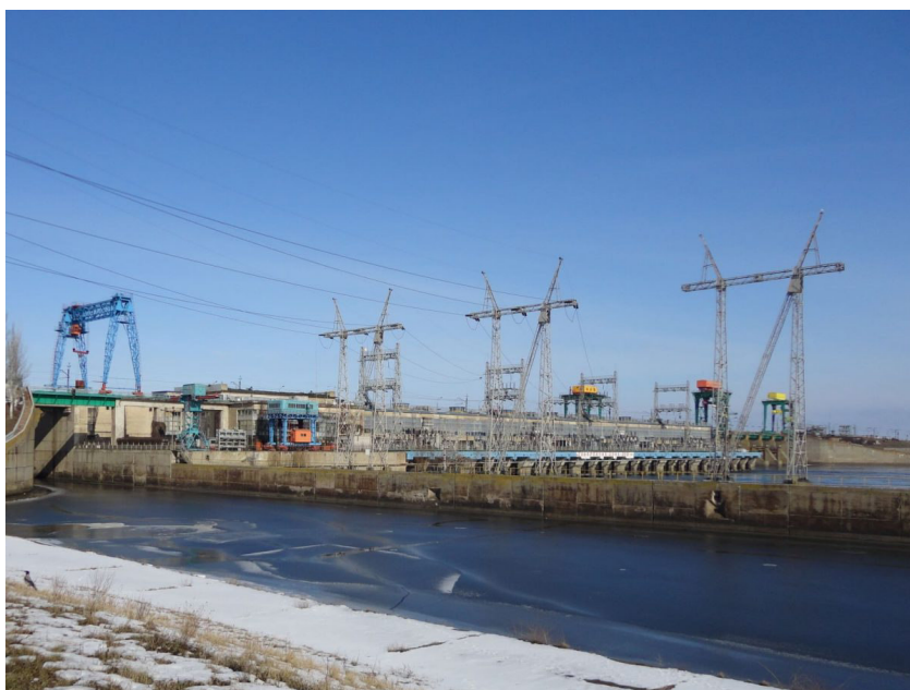
Рис. 6.13. Середньодніпровська ГЕС (потужність – 352 МВт)
