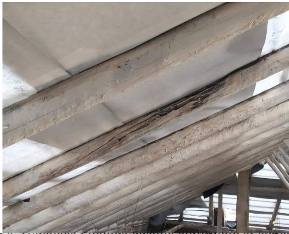
Рис.4. Пліснява і пошкодження внутрішньої обробки
