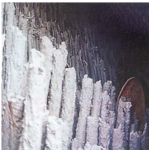
Рис 3.2 Розплавлення труб котла в результаті перегріву при нестачі води
