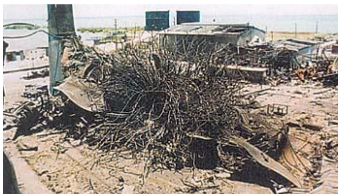
Рис. 3.1 Повне руйнування котельні як доказ небезпеки вибуху в топці
