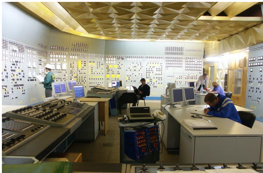
Рис. 4.8. Тренувальний пульт керування енергоблоком Хмельницької АЕС.
