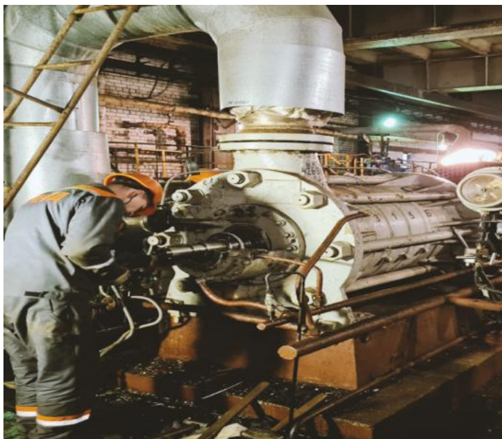
Рис 1.2 – Дільниця ремонту технологічного обладнання
