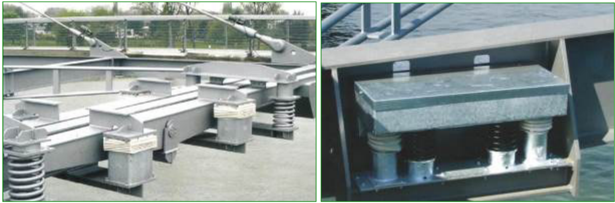
Рис. 10.8. Резонансні гасителі коливань на мосту через Рейн у Німеччині
