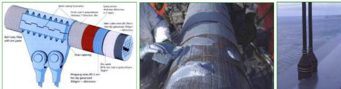
Рис. 2.5. Антикорозійний захист канатних елементів моста
