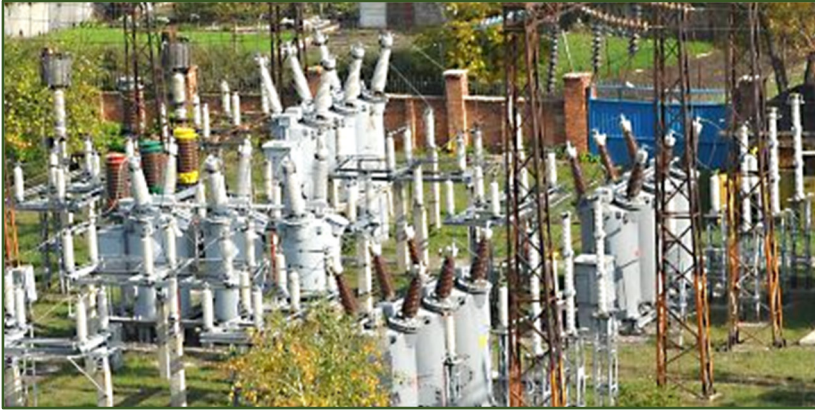
Рис. 6.5. Загальний вигляд головної понижувальної підстанції
