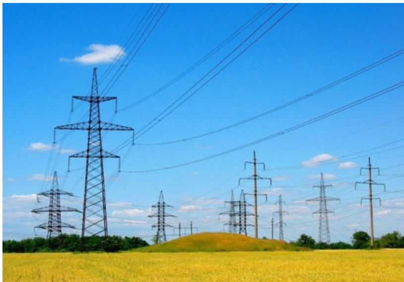
Рис. 6.2. Високовольтні лінії електропередачі (ЛЕП)
