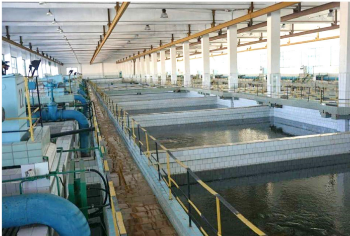
Рис. 2.9. Фільтрувальна зала ВОС
