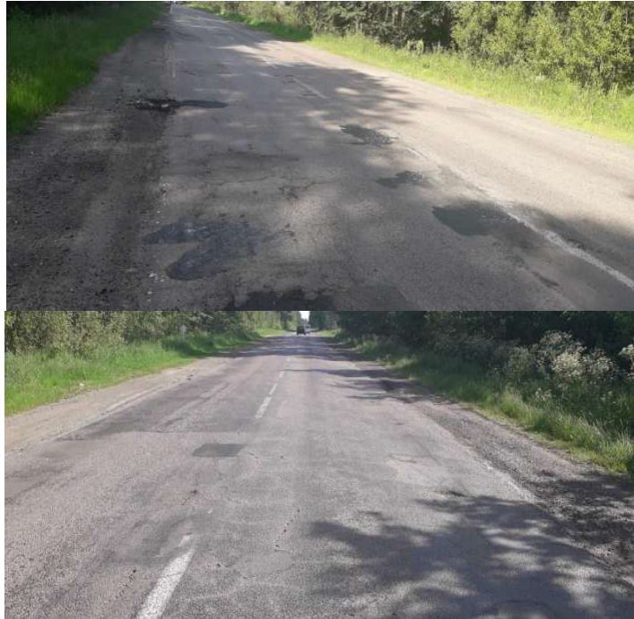
Рис. 1. Фотофіксація стану дорожнього покриття
