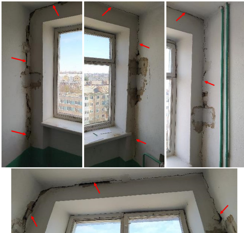
Рис. 2. Тріщини у конструкціях на поверхах будівлі
