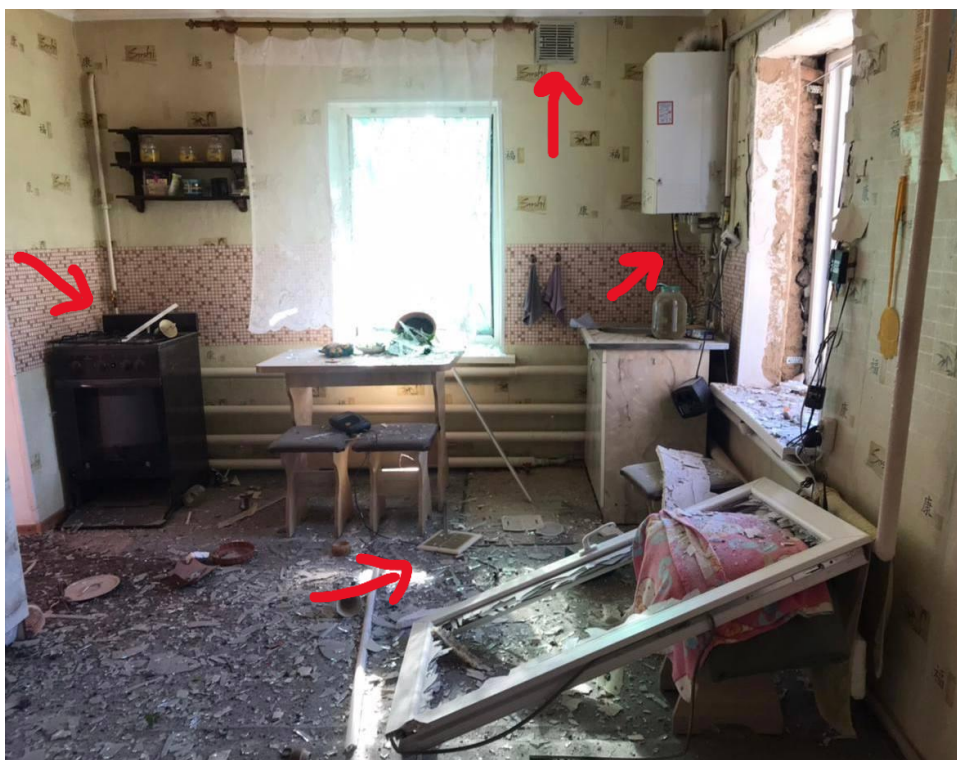
Рис. 1.5. Руйнування кухні житлового будинку [7].
