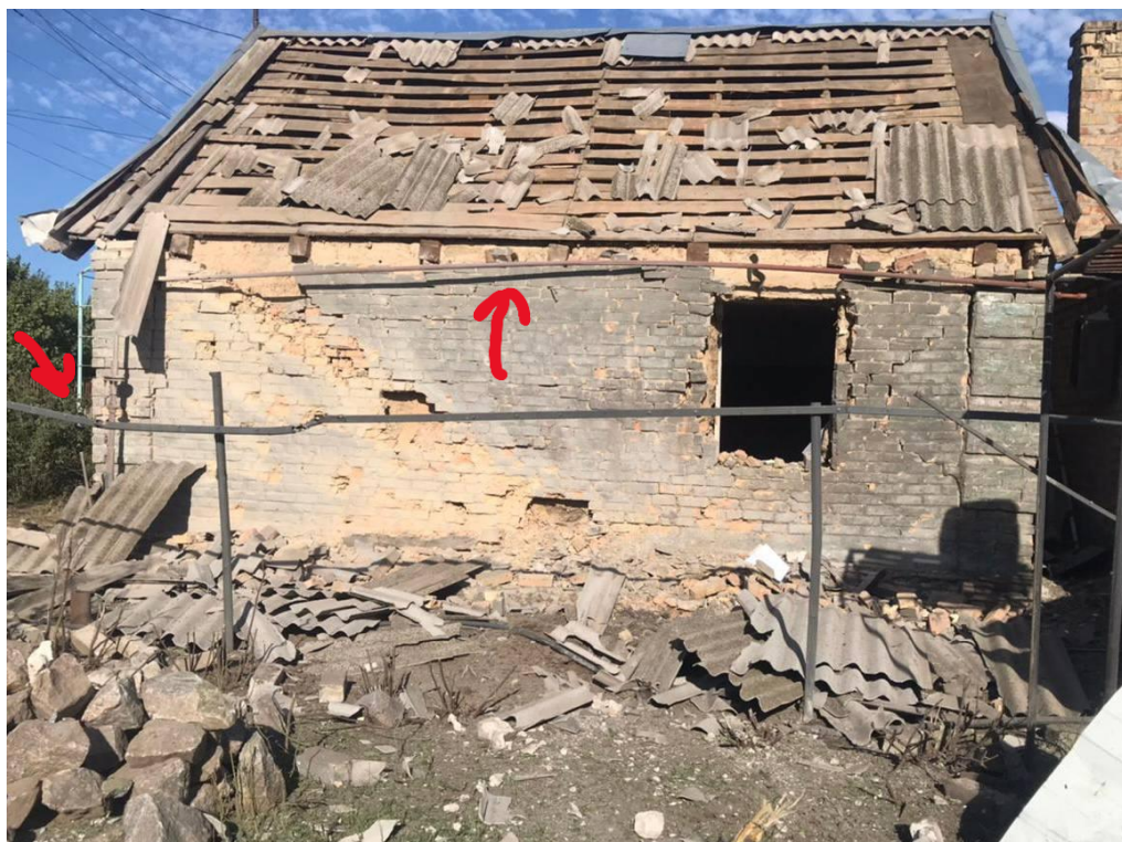
Рис. 1.7. Руйнування будинку в Нікопольському районі [7].
