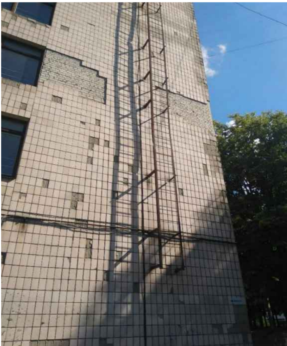
Обладнати огорожею вертикальну частину. Прибрати перешкоди
