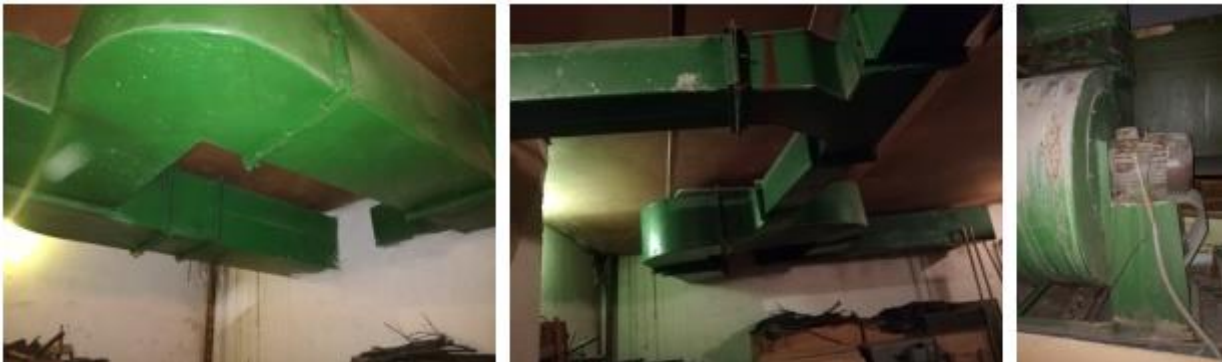
Фото 3.5 Елементи системи вентиляції навчального корпусу №6
