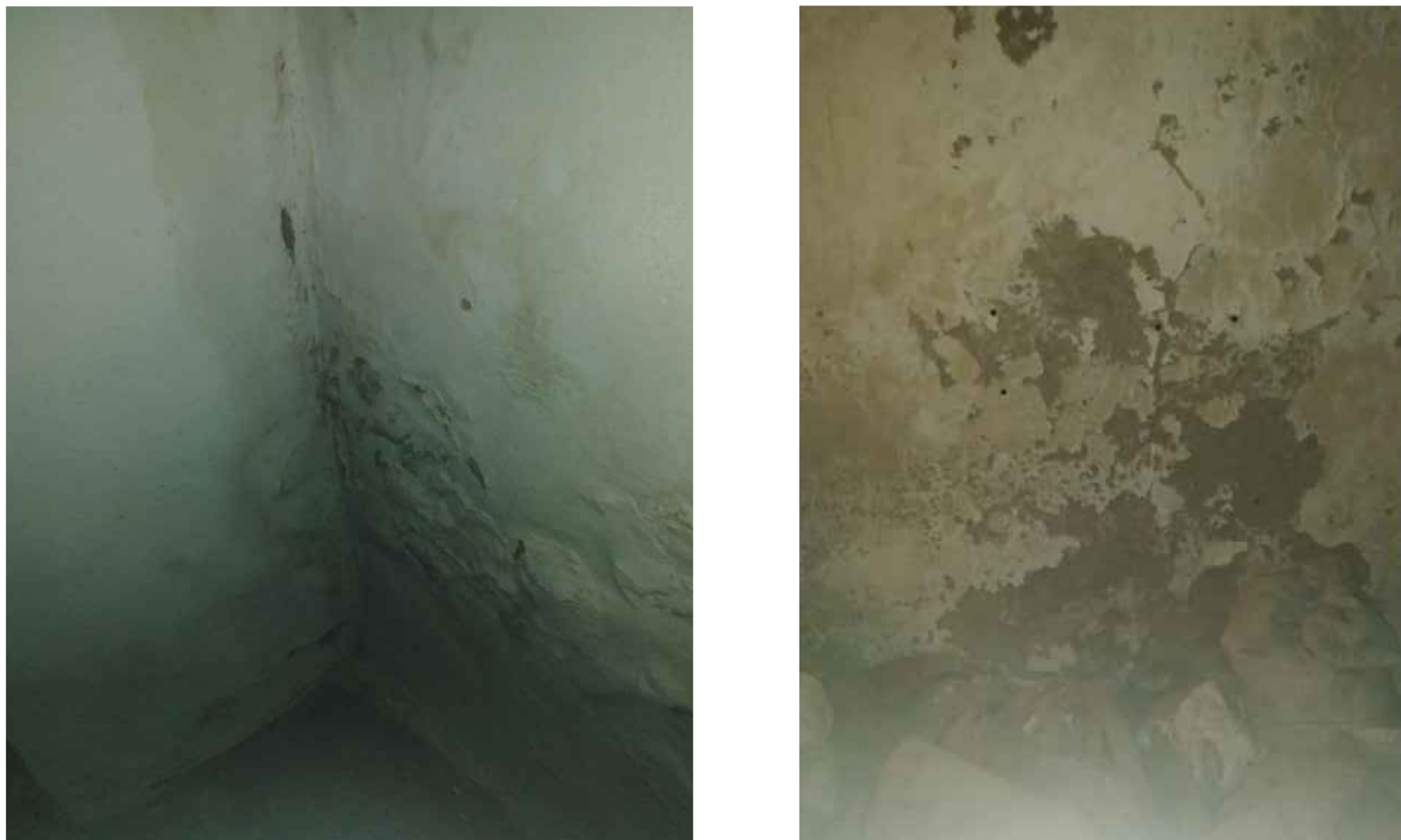
Грибок, висоли, що свідчить про відсутність або неефективність гідроізоляції та дефекти вимощення
