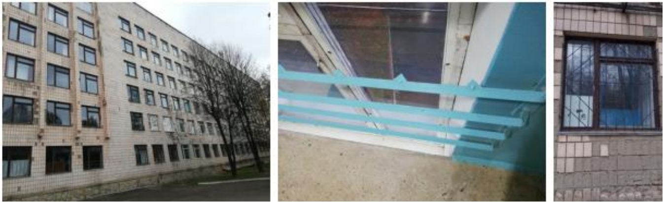
Фото 3.2 Стан вікон будівлі навчального корпусу
