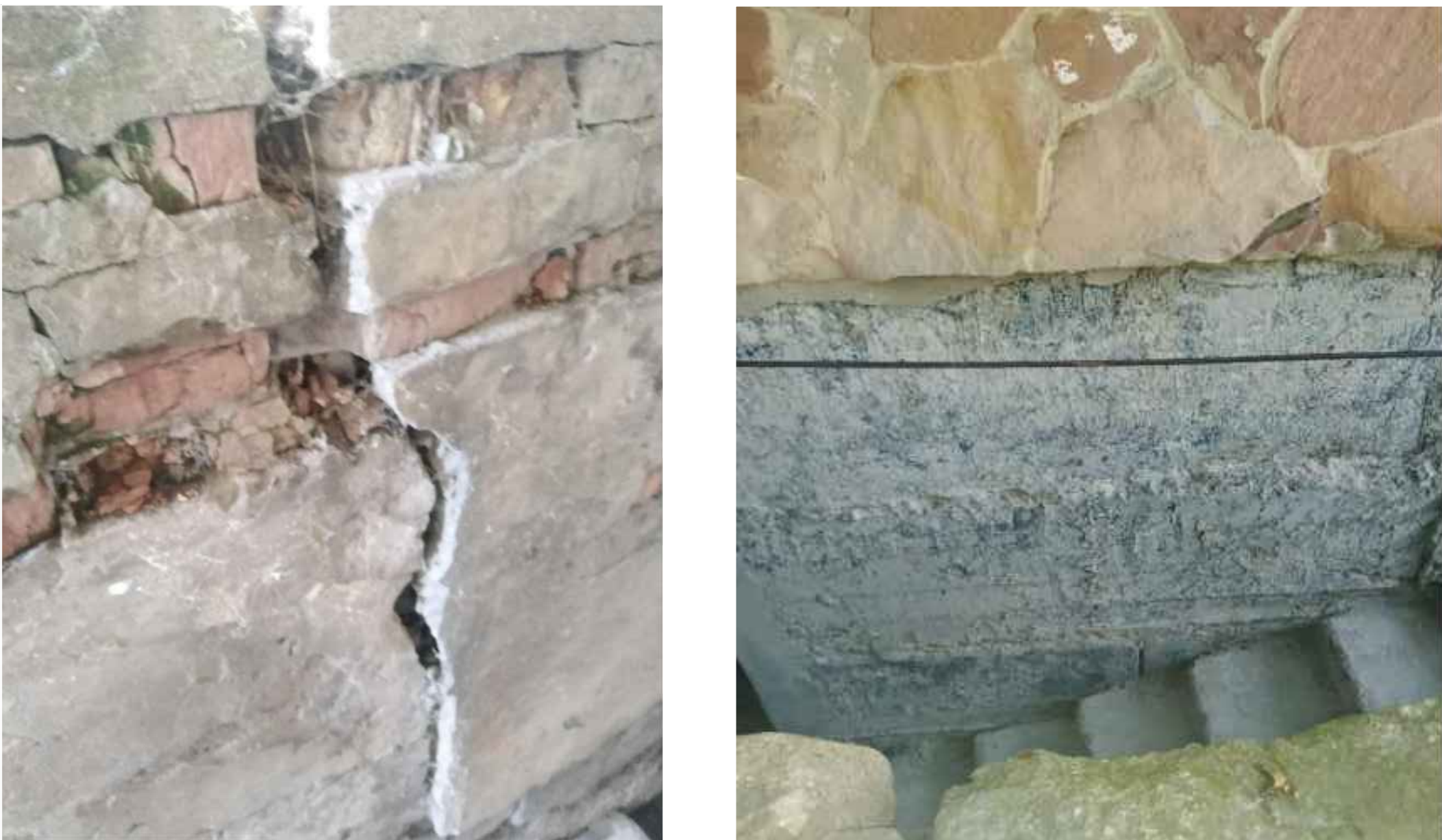
Тріщина та зміщення стіни приямку
