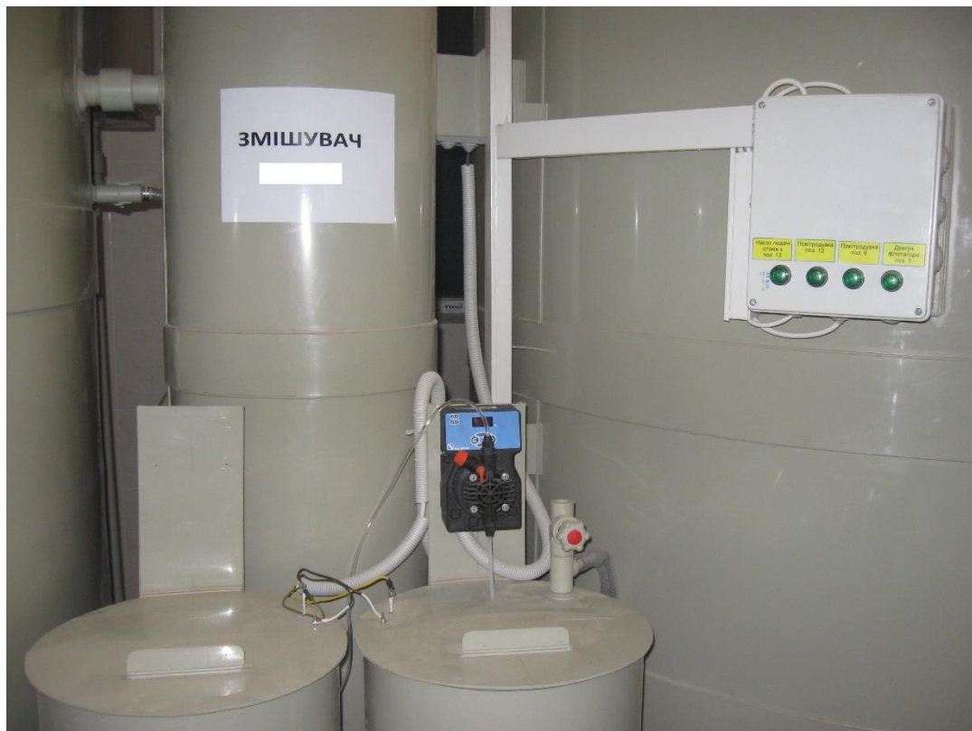
Рис. 3.27. Змішувач на промисловому модулі глибокого фізико-хімічного доочищення
