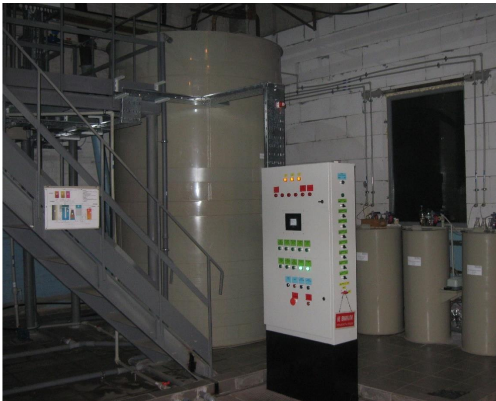
Рис. 3.26. Блок контролю та управління процесом очищення на промисловому модулі глибокого фізико-хімічного доочищення
