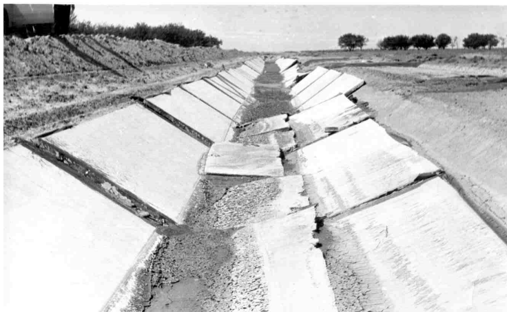
Рис. 3.37. Руйнування облицювання з залізобетонних плит при відсутності запlechиків, [1]
